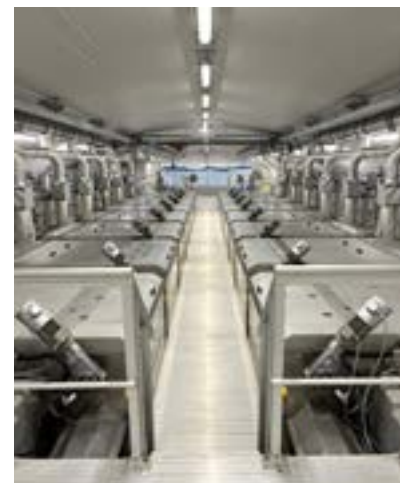
Forseparasjon med Salsnes filter.
