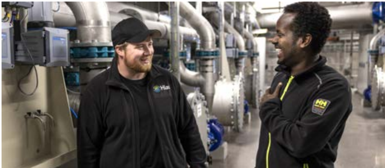
På Hias vannbehandlingsanlegg.
