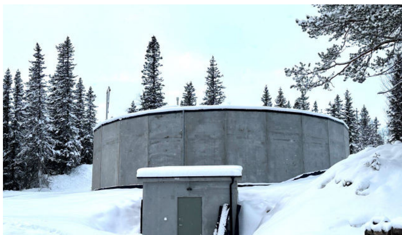
Utjevningbasseng ved Vegglifjell renseanlegg
