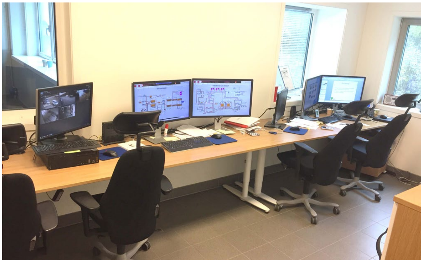
Kontrollrom på avløpsrenseanlegg. Foto: Thomas Amundsen, Bårildalen RA.
