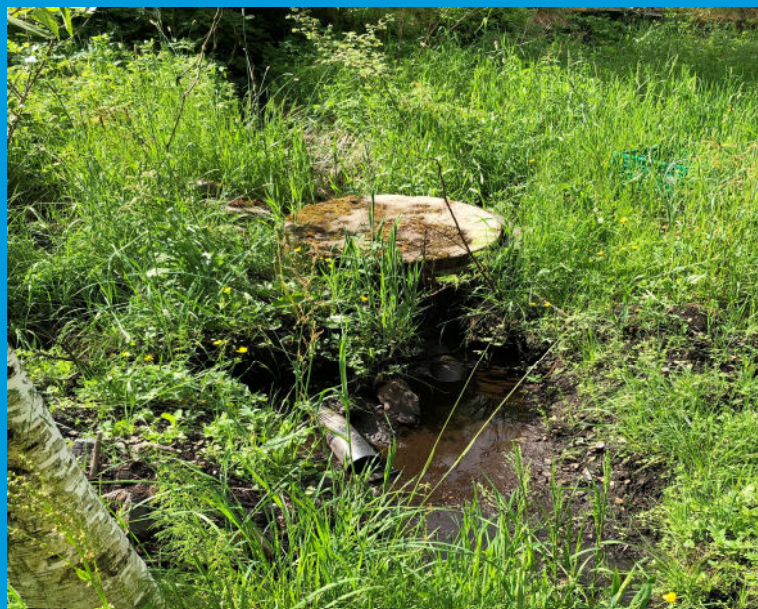
Oppstuvning av avløpsvann rundt slamavskiller
