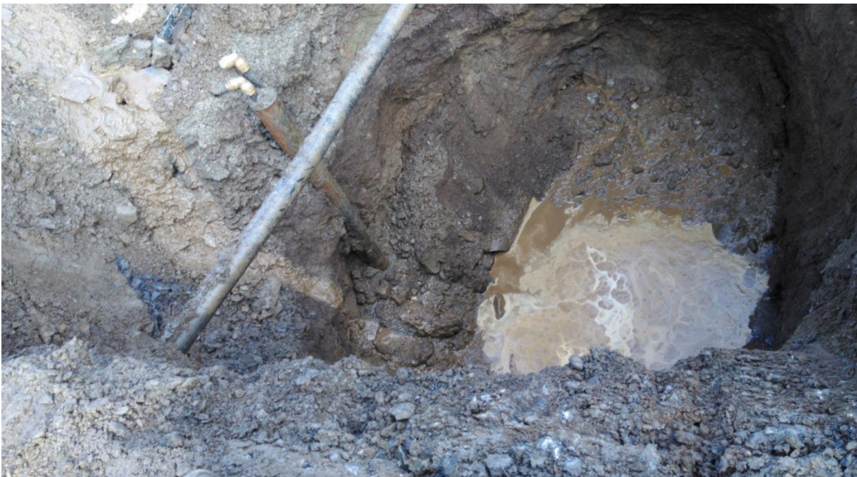
Gjennom boring av kommunalt VA. Her en 300 mm i Lindhaugsvingen i Bærum. Foto: Bærum kommune.
