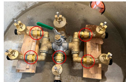
Figur 106. Koblinger (markert med røde sirkler) for enklere frakobling av ledning i kum (Foto: Odd Petter Habbestad)
