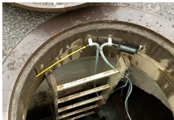
Figur 118. Fastmontert FM-antenne (gul) og sender for mobildata (svart) plassert rett under kumlokket (Foto: VAV)
