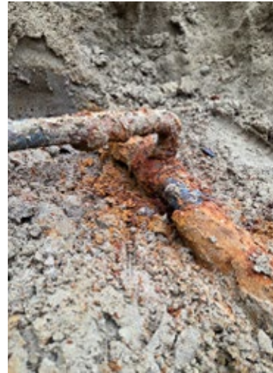
Figur 86. Lekkasje på galvanisert stålledning (Foto: GIVAS)
