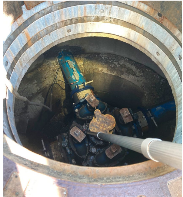
Figur 74. Clamp-on-sensorer montert på skinne med avstand tilpasset rørtype og dimensjon. Stav med festekrok for montering (Foto: Marie Sagen).
