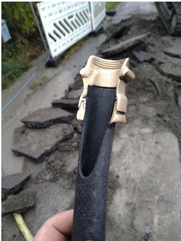
Figur 40. Lekkasjeskade på PE-ledning med rørdel av messing (Foto: Gutermann)
