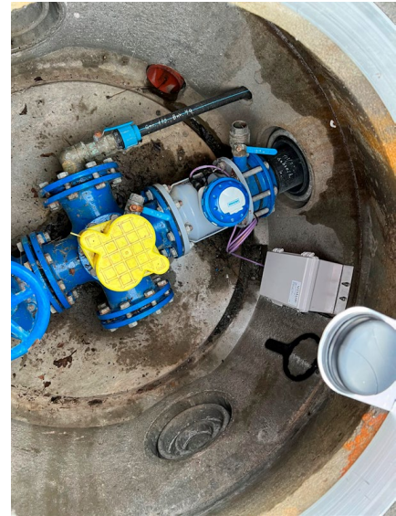
Figur 108. Vannmåler i ledningsnett, montert i eksisterende kum (Foto: Odd Petter Habbestad)
