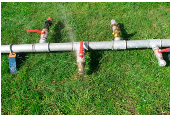
Figur 6. Sprekk i 1" messingalbue som medfører lekkasje med en vannmengde på 0,02 liter per sekund (Foto: Arnt Olav Holm)
