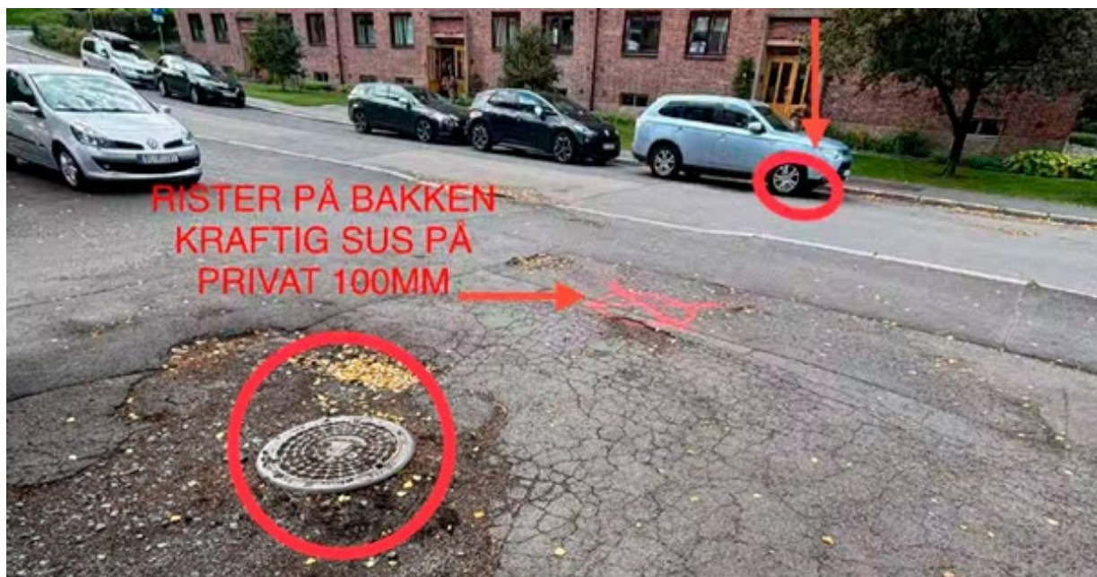
Figur 121. Eksempel på fotodokumentasjon med forklarende tekst som medfølger lekkasjerapporten (Foto: VAV)
