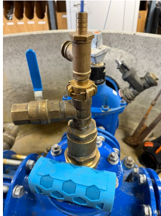
Figur 102. Innføring av stakefjær med mikrofon i kum. Lekkasje lyd via høyttaler (Foto: Odd Petter Habbestad)
