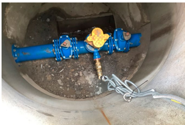
Figur 117. Hydrofon montert på mellomring under brannventil i kum. Kablene er beskyttet mot rotter (Foto: VAV)
