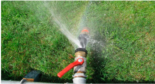
Figur 4. Lekkasje på PE-stikkledning forårsaket av utglidning i skjøt, med registrert vannmengde på 0,2 liter per sekund (Foto: Arnt Olav Holm)
