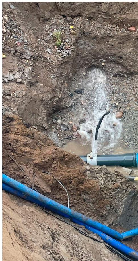
Figur 41. Lekkasje på an boring på PVC-rør (Foto: Gutermann)
