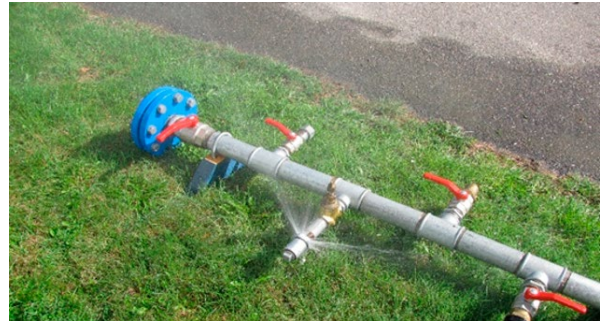
Figur 5. Lekkasje i 1" galvanisert blindstykke som utgjør en vannmengde på 0,11 liter per sekund (Foto: Arnt Olav Holm)
