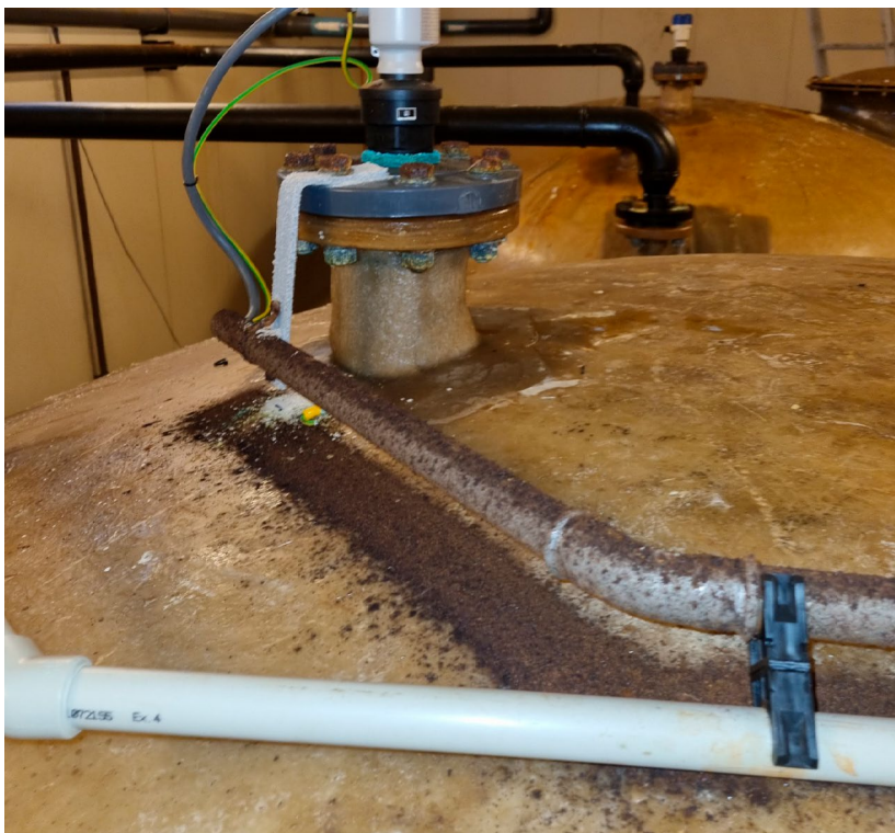
Figur 38: Korrosjon på bolter og rør på topp av lagertank for jernklorid. Over tid har et tykt lag rust drysset ned fra jernrøret.
