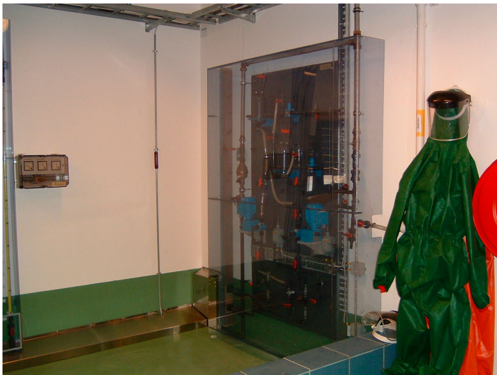
Figur 44: Fra klordoseringsanlegget ved Rosse vannverk i Kristiansand. Doseringssystemet er plassert oppe i bingen og bak gjennomsiktig skjerm. Personlig verneutstyr henger klart på stedet. Foto: Fredrik B. Ordning
