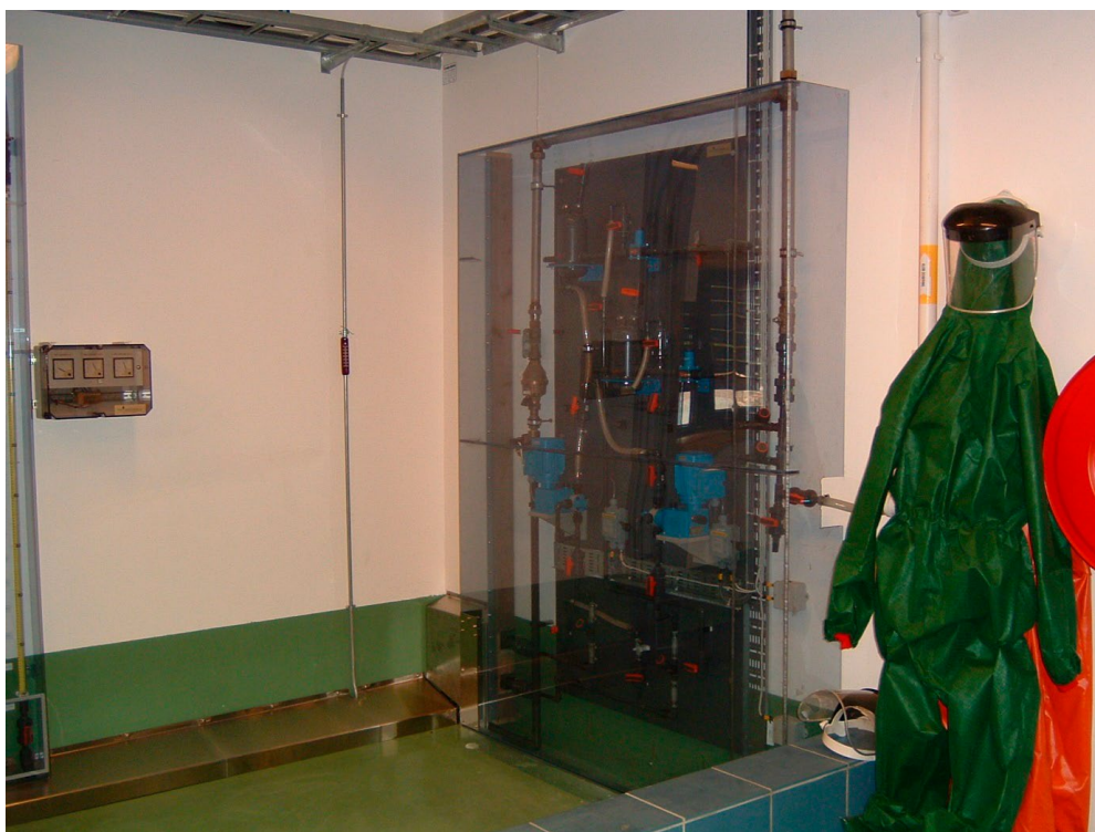
Figur 68: Fra klordoseringsanlegget ved Rossevann vannverk i Kristiansand. Doseringssystemet er plassert inne i bingen og bak gjennomsiktig skjerm. Personlig verneutstyr henger klart på stedet. Foto: Fredrik B. Ording
