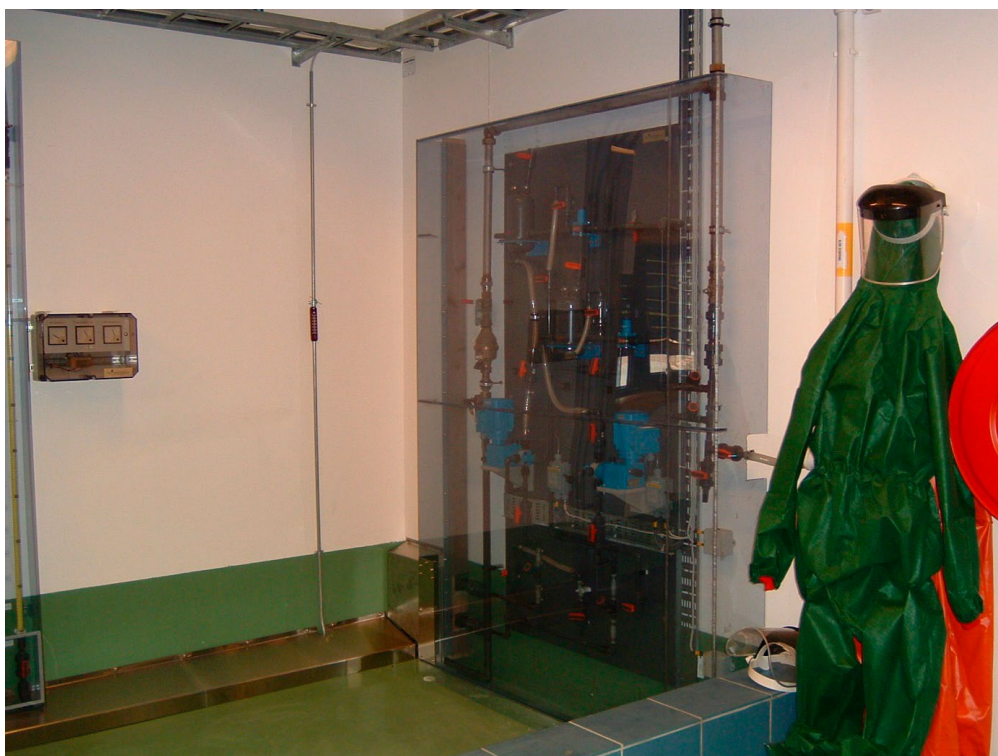
Figur 29: Fra klordoseringsanlegget ved Rosse vannverk i Kristiansand. Doseringssystemet er plassert i/over bingen og bak gjennomsiktig skjerm. Personlig verneutstyr henger klart på stedet. Foto: Fredrik B. Ordning
