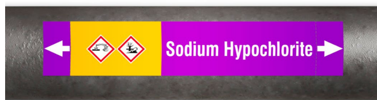
Figur 2: Eksempel på merking av rør i henhold til NS-ISO 20560. (For ordens skyld: merkingen skal være på norsk.) Bilde: Brady Corporation, www.brady.no .
