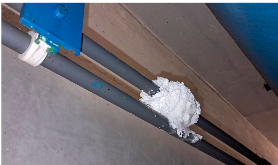
Figur 11: Klump av lut som er avsatt gjennom årene på grunn av en mikroskopisk lekkasje i limte PVC-rør. Foto: Fredrik B. Ording
