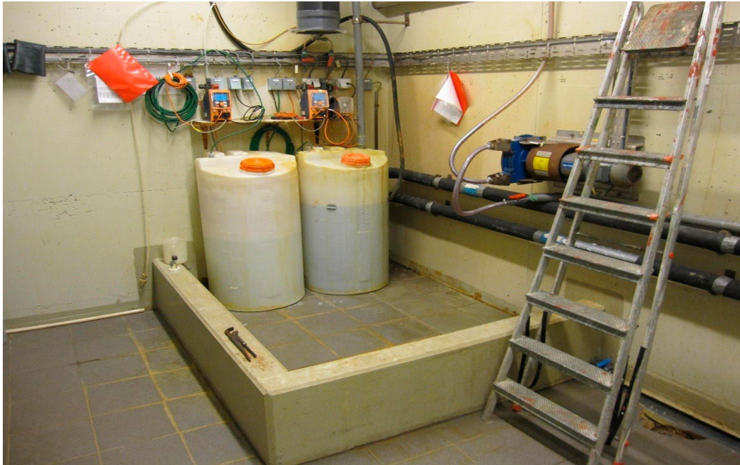
Figur 57: Eksempel på dårlig sikkerhet mot blanding: de to tankene inneholder hhv. klor (natriumhypokloritt) og jernklorid.
