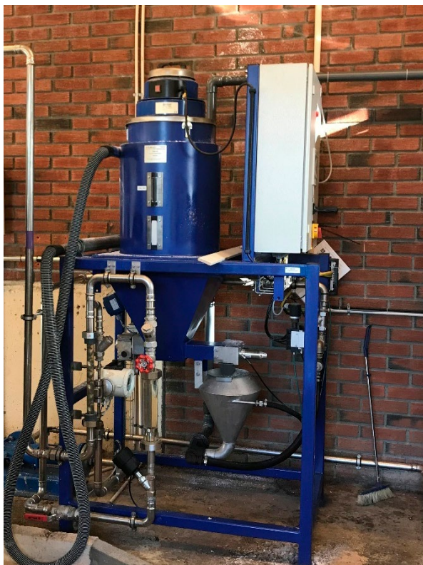
Figur 93: Anlegg for polymer i pulverform. Til venstre sugeslange for overføring fra sekk til silo, under i midten innblandingsenhet. Foto Eline Klaastad, Asplan Viak AS
