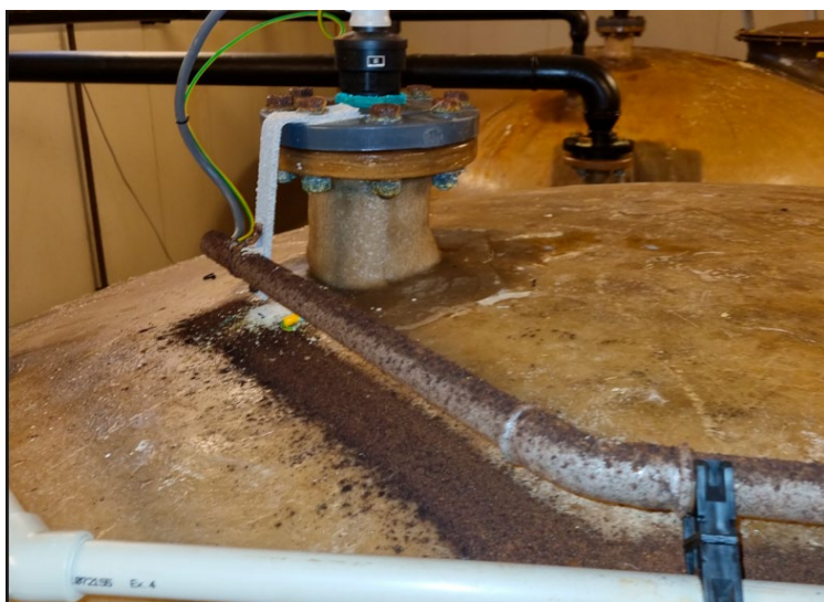
Figur 75: Illustrasjonsfoto: Korrosjon på bolter og rør på topp av lagertank for jernklorid. Over tid har et tykt lag rust drysset ned fra jernrøret. Konsentrert saltsyre er mer aggressiv enn jernklorid.
