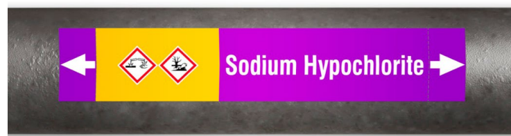
Figur 41: Eksempel på merking av rør i henhold til NS-ISO 20560. (For ordens skyld: merkingen skal være på norsk.) Bilde: Brady Corporation, www.brady.no .
