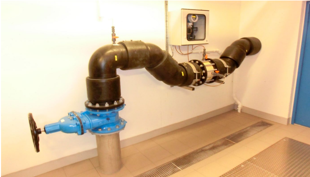
Figur 51: Dosering til spesialbygget mikser i PE, satt inn på et senket rørstrekk av PE. Gjerstad vannverk. Foto: Fredrik B. Ording
