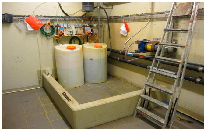
Figur 45: Eksempel på dårlig sikkerhet mot blanding: de to tankene inneholder hhv. klor (natriumhypokloritt) og jernklorid.
