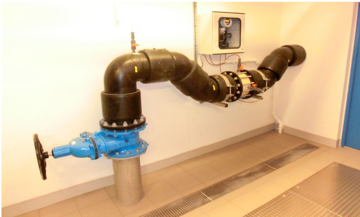
Figur 87: Doseringsskap og doseringspunkt med senket rørstrekk og spesialbygget mikser i PE. Bildet viser doseringspunkt for jernklorid ved Gjerstad vannverk, men samme prinsipp bør brukes for saltsyre. Foto: Fredrik B. Ording
