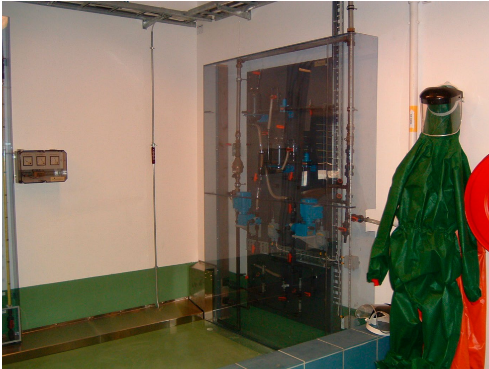
Figur 80: Fra klordoseringsanlegget ved Rossevann vannverk i Kristiansand. Doseringsutstyret er plassert opppe i bingen og bak gjennomsiktig skjerm. Personlig verneutstyr henger klart på stedet. Foto: Fredrik B. Ording
