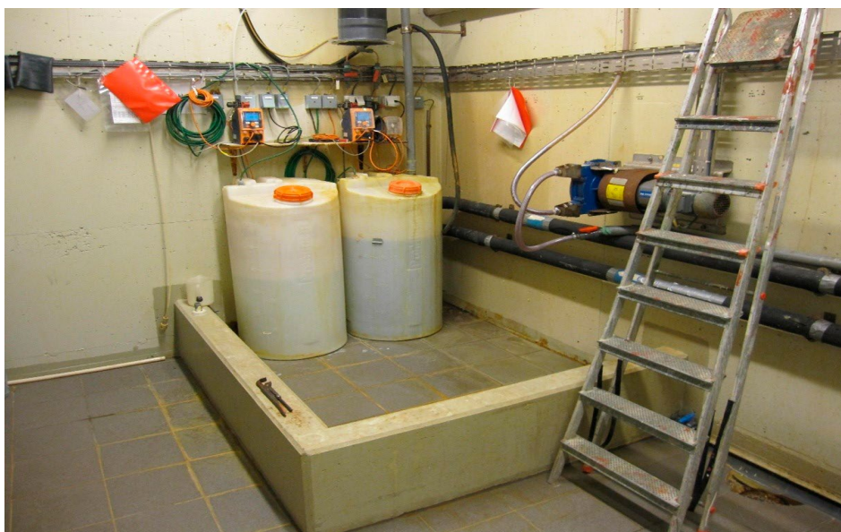
Figur 81: Eksempel på dårlig sikkerhet mot blanding: de to tankene inneholder hhv. klor (natriumhypokloritt) og jernklorid.
