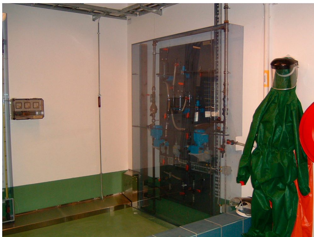
Figur 5: Fra klordoseringsanlegget ved Rosse vannverk i Kristiansand. Doseringssystemet er plassert oppe i bingen og bak gjennomsiktig skjerm. Personlig verneutstyr henger klart på stedet. Foto: Fredrik B. Ording, Asplan Viak.
