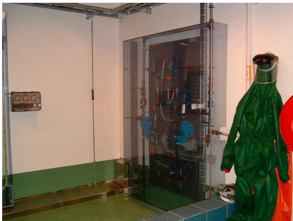
Figur 17: Fra klordoseringsanlegget ved Rossevann vannverk i Kristiansand. Doseringssystemet er plassert inne i bingen og bak gjennomsiktig skjerm. Personlig verneutstyr henger klart på stedet. Foto: Fredrik B. Ordning
