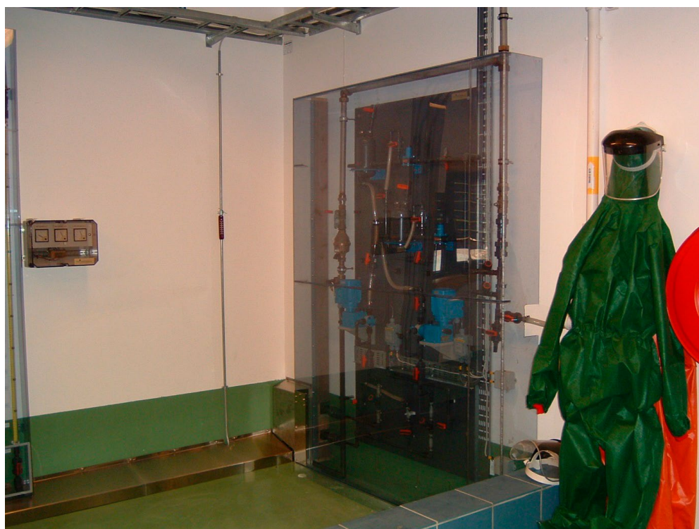
Figur 56: Fra klordoseringsanlegget ved Rossevann vannverk i Kristiansand. Doseringssystemet er plassert inne i bingen og bak gjennomsiktig skjerm. Personlig verneutstyr henger klart på stedet. Foto: Fredrik B. Ordning
