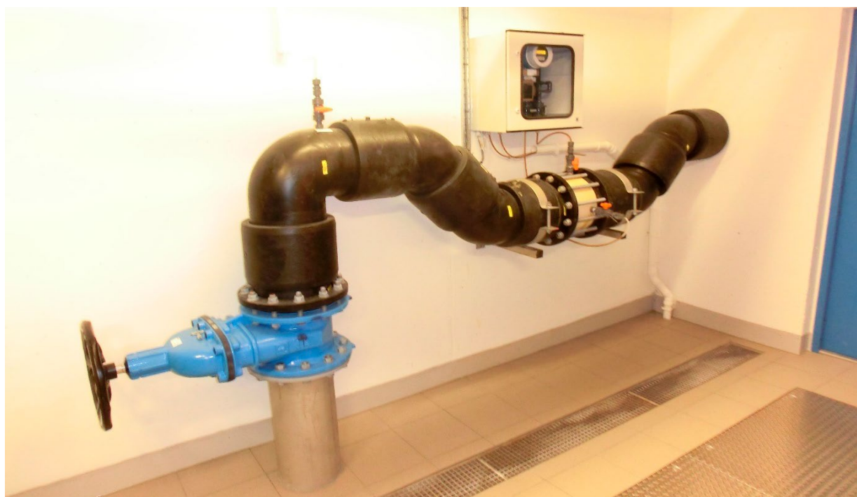
Figur 63: Dosering til spesialbygget mikser i PE, satt inn på et senket rørstrekk av PE. Gjerstad vannverk. Foto: Fredrik B. Ording
