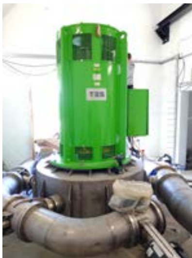
Turbin og generator er på plass. Når denne settes i drift vil drammensere pusse tenner i vann som er blitt brukt til produksjon av strøm først.
