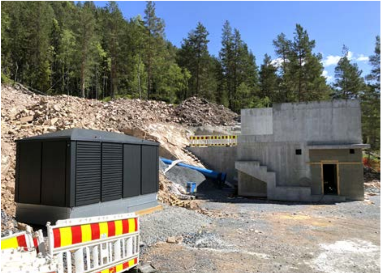
Kraftstasjonen på Øvre Åssiden og trafoen som skal mate strøm inn på nettet.
