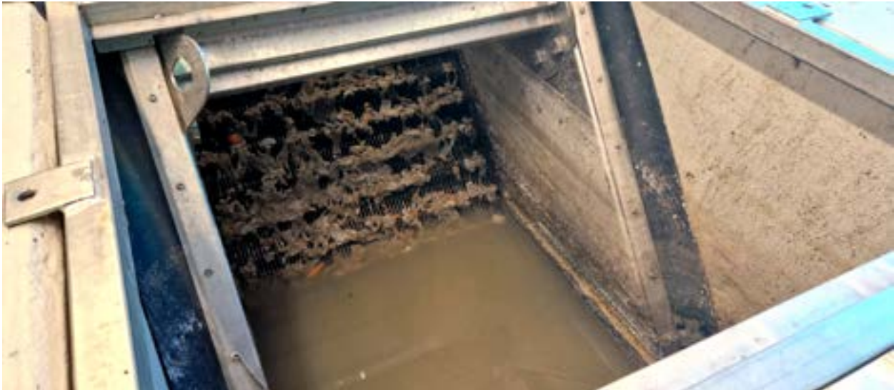
Illustrasjonsfoto: Rist for fjerning av avløpssøppel Foto: Bårlidalen renseanlegg
