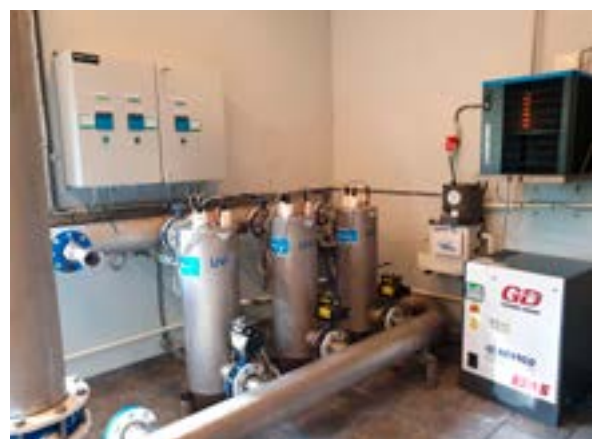
UV-anlegget ved Hellvik vannverk i Eigersund kommune
