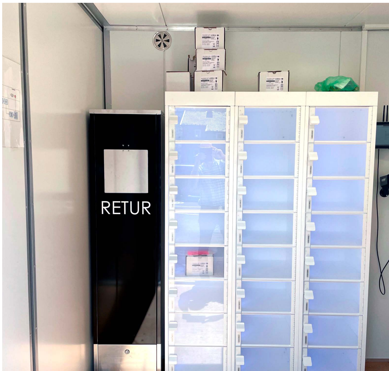
Vanmålerkiosken gjør hverdagen mer effektiv for rørleggerne, som kan hente vannmålere når det passer dem.
