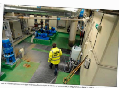
Med de investeringene som trengs for å sikre trykkløst vann til alle husholdninger og næringslivet, vil kommunene trenge 332 milliarder kroner til oppgradering av vann- og avløpsanlegg. Det viser en rapport fra Norconsult og Sintef, som er lagd for Norsk Vann. Beløpet tilsvarer en femtedel av statsbudsjettet for 2022.
