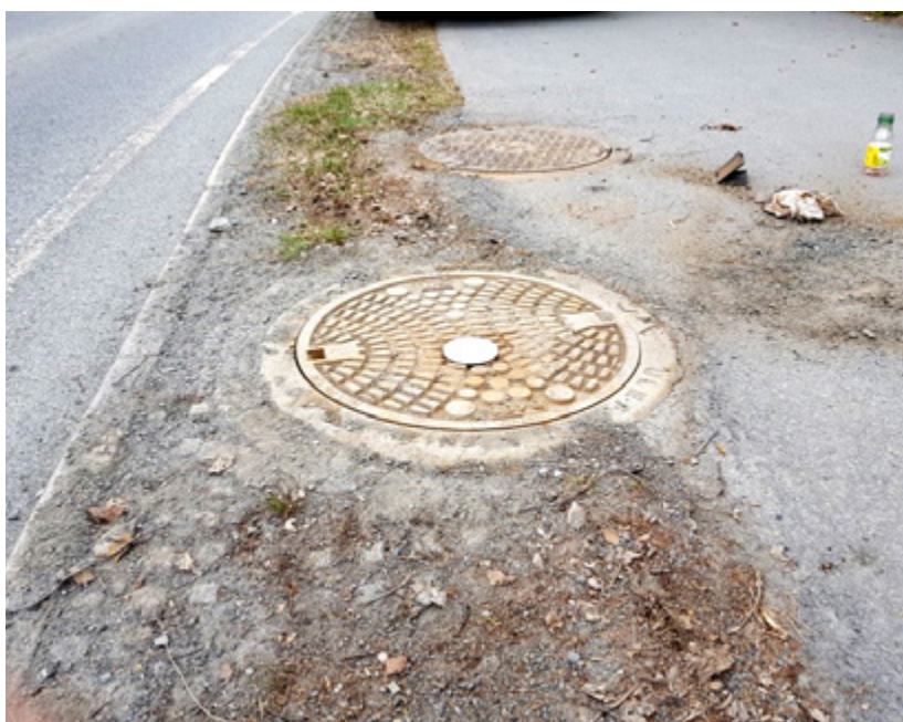
Kumlokk med påmontert sensorantenne
