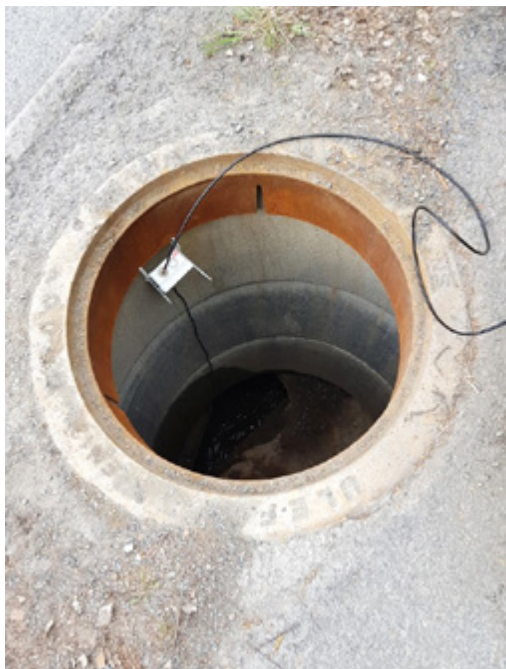
Sensorantenne i Nadderudbekken
