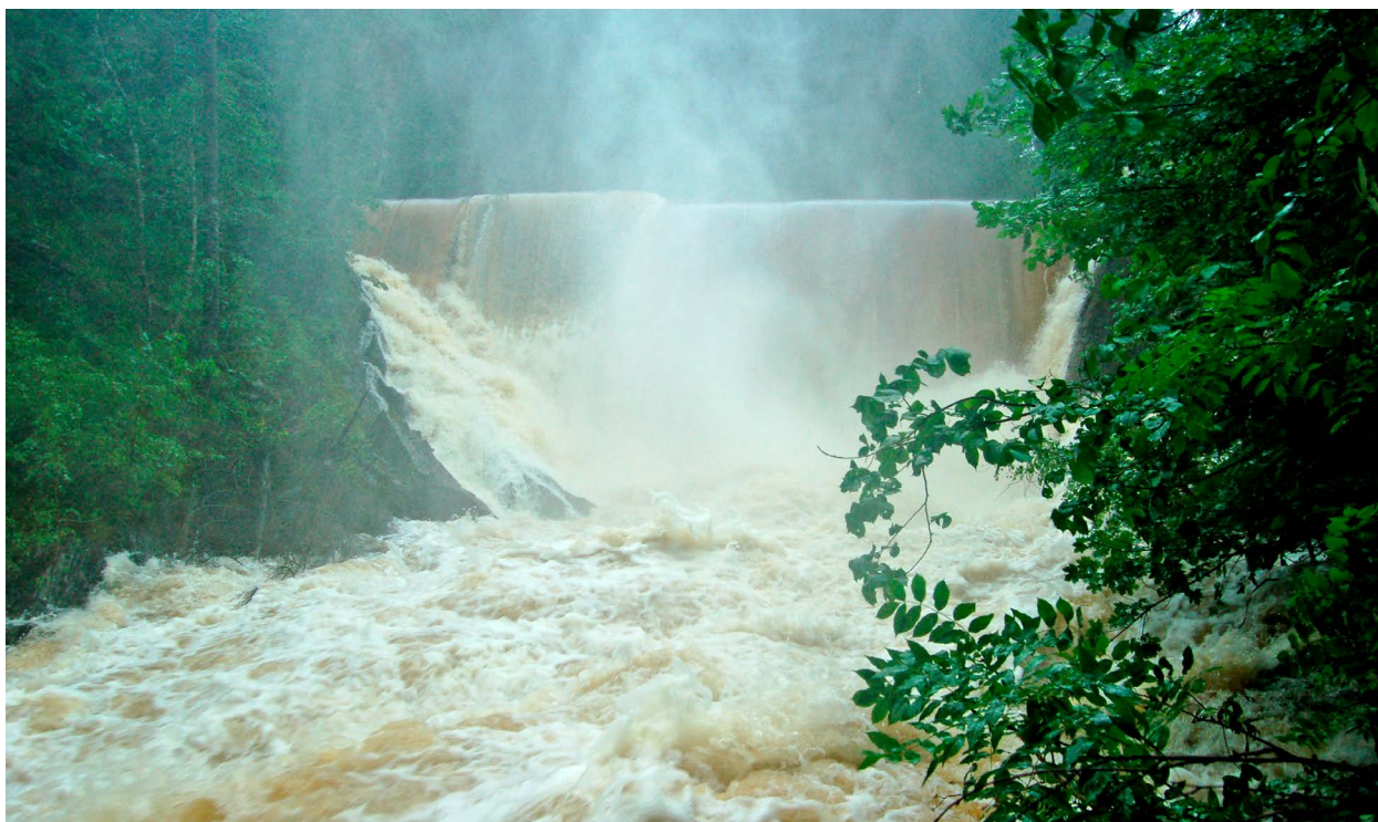
Flom i Høgfosdammen. Foto: Terje Røren
