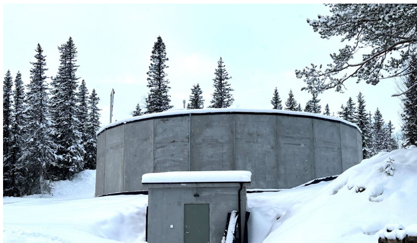
Utjevningsbasseng ved Veggli fjell renseanlegg
