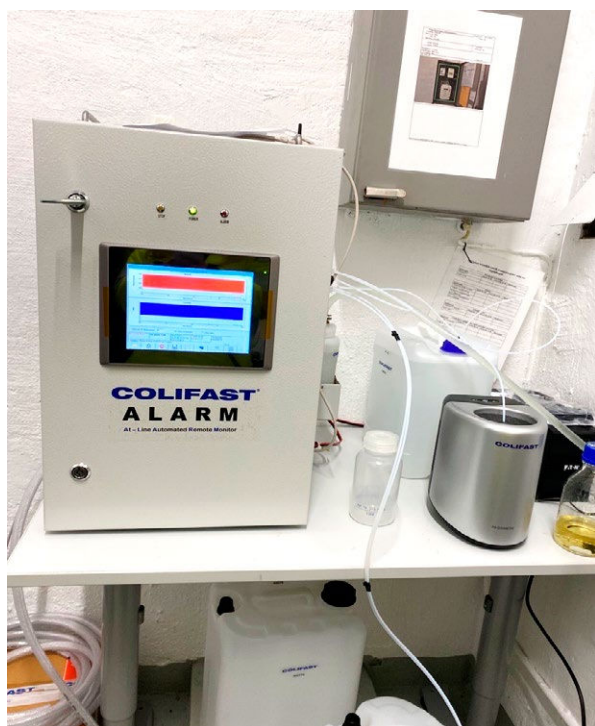
Figur 10: Colifast ALARM installert på en pumpestasjon på distribusjonsnettet.
