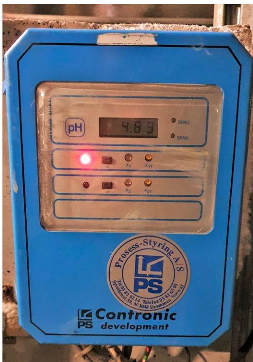
Figur 21: pH-måler som er forglemt. «Ingen» vet hvem som har installert eller hvorfor. Måleren viser en pH på 4,89, altså langt under grenseverdien i drikkevannsforskriften. Rutineprøver i området viser normal pH på 7,5. Manglende oppfølging, kalibrering og vedlikehold gjør at vi får uriktige verdier.
