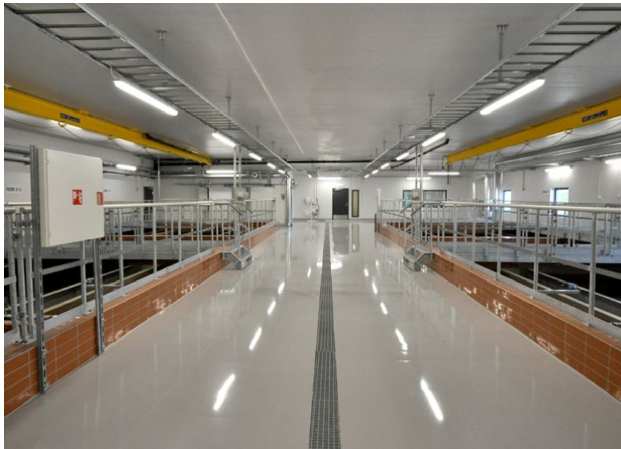
Hurdalssjøen vannbehandlingsanlegg. Foto: Ullensaker kommune
