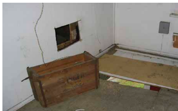
Figur 40: Fra andre etasje og opptil loftet var det saget et hull på ca 1 m2. Dette kunne spre brannen fritt opp på loftet, men vanntåken hindret overtenning så lenge vannet ble påført.
