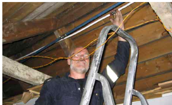
Figur 39: Vanntåkedyser ble plassert oppe under taket på loftet i bygningen.
