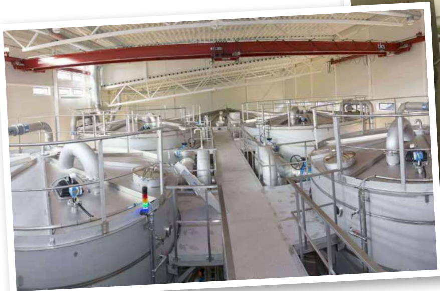
Flåte vannbehandlingsanlegg, Bamble kommune
