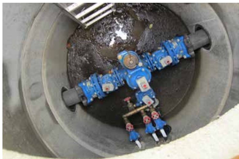
Figur 10.6: Vannkum med tre stikkledninger. De hvite feltene nærmest kumveggen er adresseplatene som viser hvor hver ledning går. De blå delene rett før adresseplatene er tilbakeslagsventiler. Foto: Hilde Sandstedt, Rana kommune
