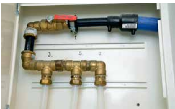
Figur 11.2: «Rør-i-rør» system er ført inn i leilighet og avsluttet i fordelingsskap. Foto: Arve Hansen
