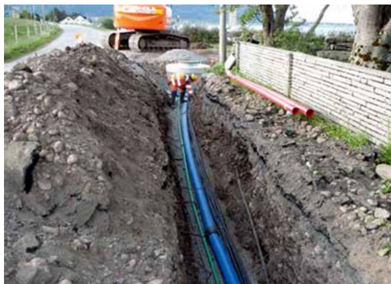
Figur 10.3: Bunting av stikkledning, Haram kommune. På dette bildet er stikkledninger lagt litt for nær hovedledning. Kommunens beskrivelse er at de skal legges i samme nivå som vannledning med 10 cm avstand fra andre ledninger, og bunta hver andre meter med strips. Til venstre en fiberkabel. Foto: Nils Kristen Skaar, Haram kommune.
