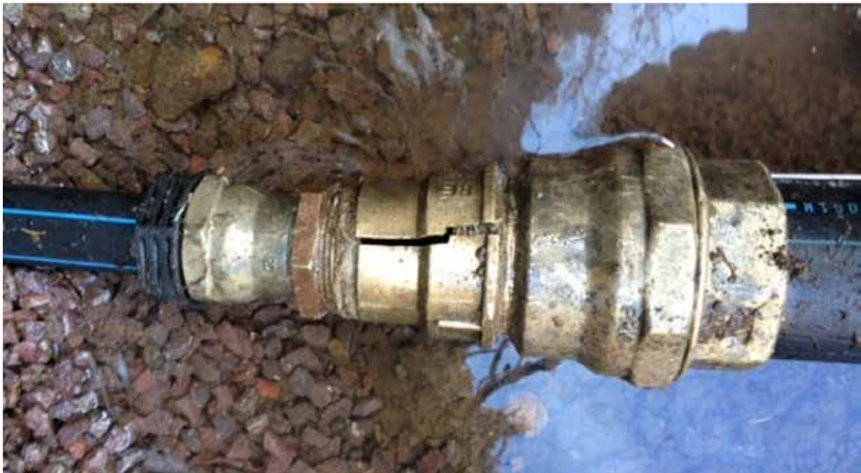
Figur 2.4: Her er resultatet av feil montering av messingdeler etter ca. 1 år: både muffe og overgang er sprukket. Foto: Arnt Olav Holm, Vestfold Vann
