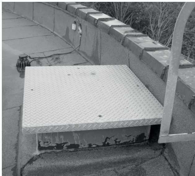
Figur 6.18: Adkomstluke på flatt tak. Luke er festet med bolter. For inspeksjon av vannoverflate må en ned i basseng. Sluk på tak og elektrisk varmeelement er ofte problempunkter.
