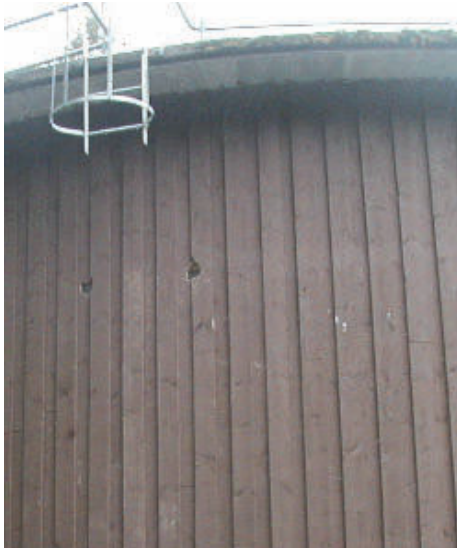
Figur 10.1: Utvendig panel bearbeidet av hakkespett.
