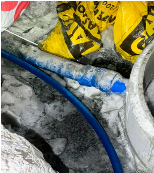
Figur 8-17: Frostutsatt montering uten tilstrekkelig isolasjon. Dette kan føre til dårlig komprimering og setninger.
