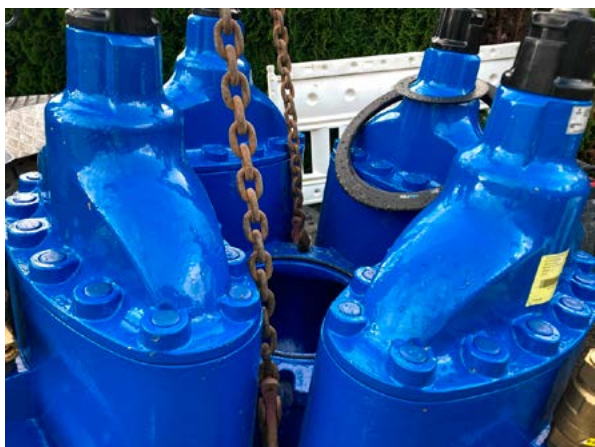
Figur 8-12: Kjettingen ligger direkte mot beskyttelsesbelegget til ventilen. Det skal benyttes et beskyttende mellomlag (f.eks. gummi eller tekstil) mellom kjetting og ventilens overflate.
