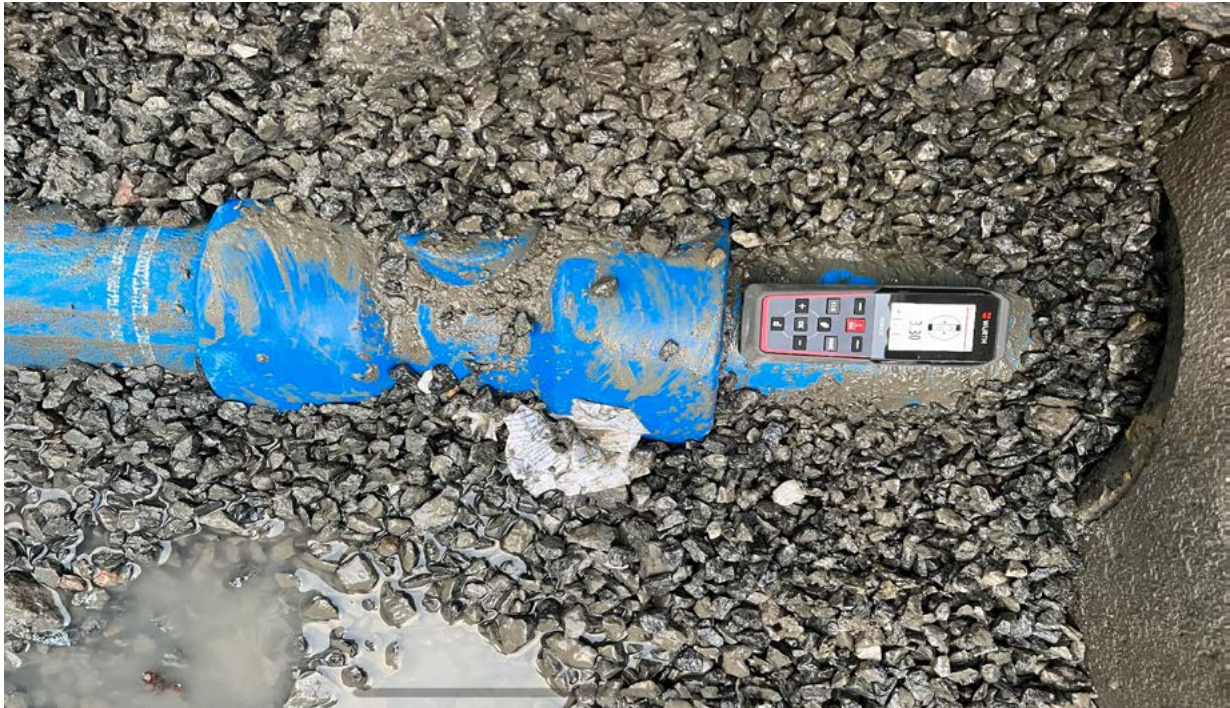
Figur 7-18: Vannledning med spissende som ikke er tredd tilstrekkelig inn i muffen. Spissenden skal føres inn til den første hvite stripen for å sikre korrekt tetting.
