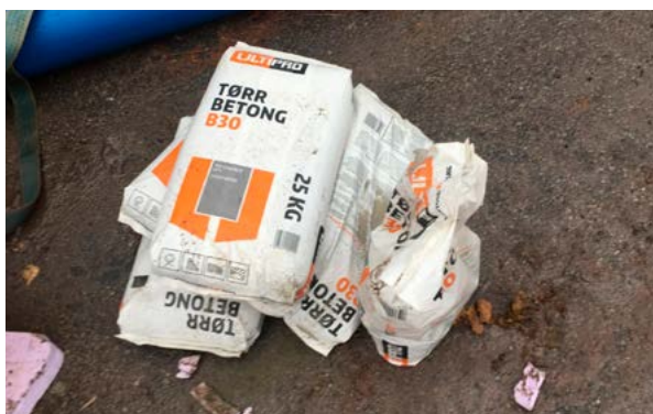
Figur 7-11: I VA-normen til kommunen stilles det krav til betongklasse B35. Her er det blitt benyttet B30.
