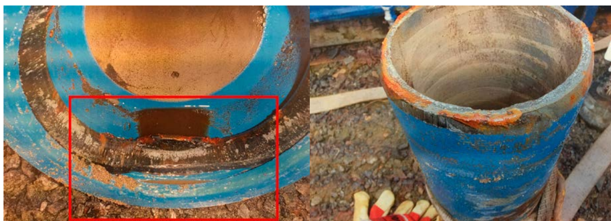
Figur 8-5: Støpejernsrør til vannledning i et nyanlegg. Til venstre ser man at pakningen ikke ligger riktig i sporet (markert med rød firkant), som skyldes at kappeenden (til høyre) ikke er spisset godt. Dette fører til manglende tetting av røret og lekkasje. Videre, viser røret tegn til rustdannelse og avskallinger på innsiden.
