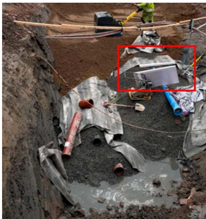
Figur 7-5: XPS-isolasjonen skal ligge minimum 30 cm over røret, men her ligger den direkte oppå røret (rød firkant). I tillegg er det veldig rotete.
