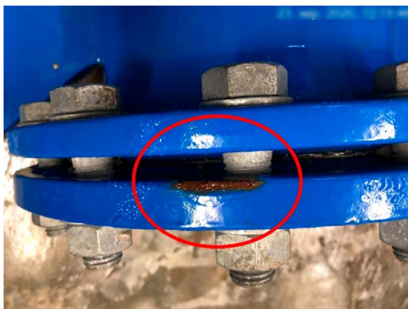
Figur 8-4: Skade på beskyttelsesbelegget på flensedel med synlig rust. Skaden skyldes slagskade som har oppstått før montering.
