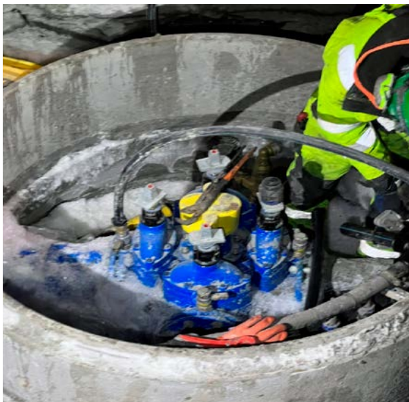
Figur 8-11: Dårlig beskyttelse og mangelfull isolasjon av ventiler under anleggsperioden.
