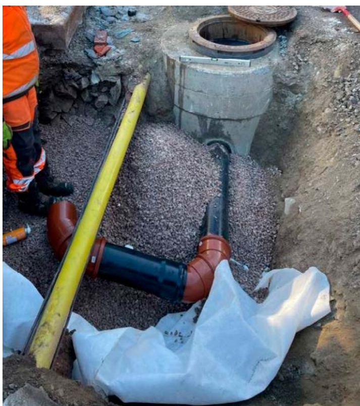
Figur 8-3: Ledningsstrekket ut fra kummen er ikke hensiktsmessig med tanke på retning og påkobling. To 45-graders kortbend er benyttet for å oppnå ønsket retning, noe som indikerer feilbestilling eller feilplassering av kum.
