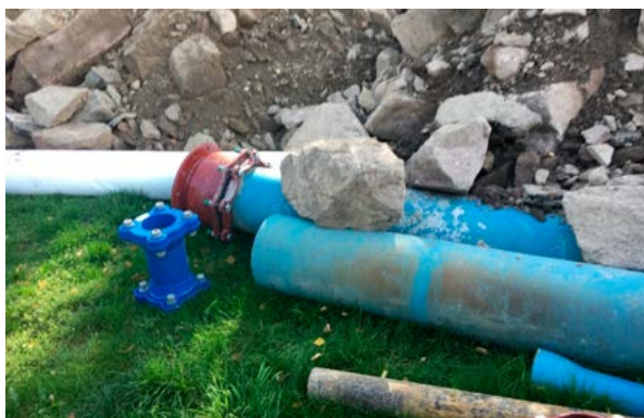
Figur 7-13: Rør og deler er oppbevart uten tilstrekkelig beskyttelse. Det brune belegget på røret er stålrester fra stålsprut, som har kommet fra kapping av et annet stålrør rett ved siden av.
