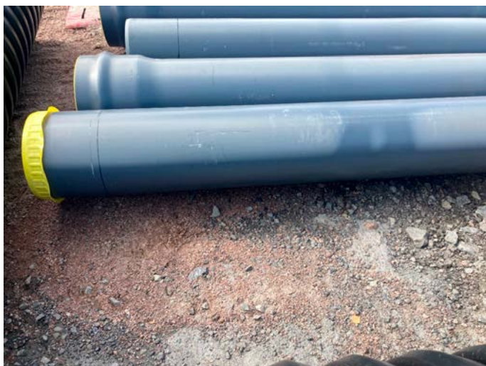
Figur 7-16: Misfarging av plastrør, trolig som følge av eksponering for sollys. Flere kommuner godkjenner ikke bruk av misfargede plastrør, selv om rørprodusenten vurderer dette som akseptabelt.
