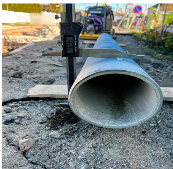
Figur 7-17: Kappeenden på et støpejernsrør. Røret er kappet utenfor kalibreringsområdet, med et avvik på 1,34 mm over maksimums-mål. Røret skal måles før kapping for å sikre korrekt utførelse. Dette er en utførelsesfeil.
