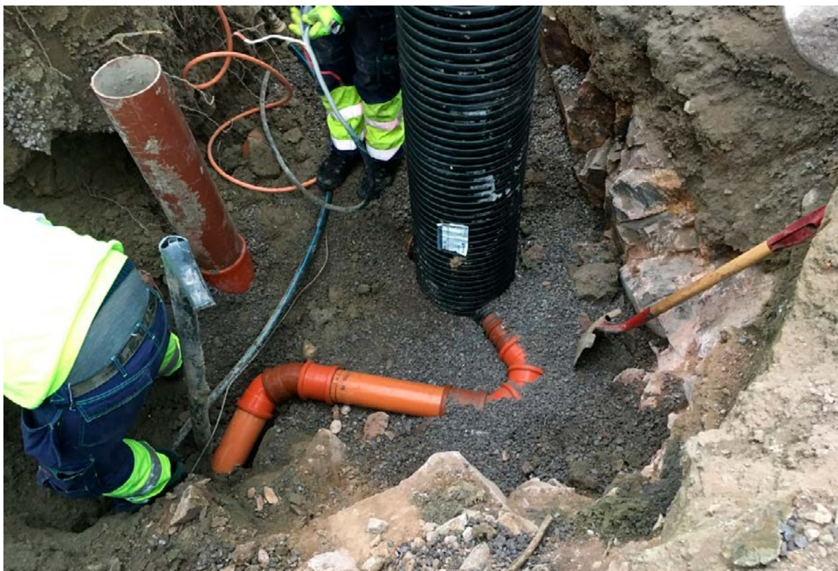
Figur 5-1: Eksempel på rør som er lagt ugunstig med flere kortbend, i stedet for å legge rørene i en rett strekning. Denne utførelsen er hydraulisk ugunstig og øker risikoen for tilstopping.
