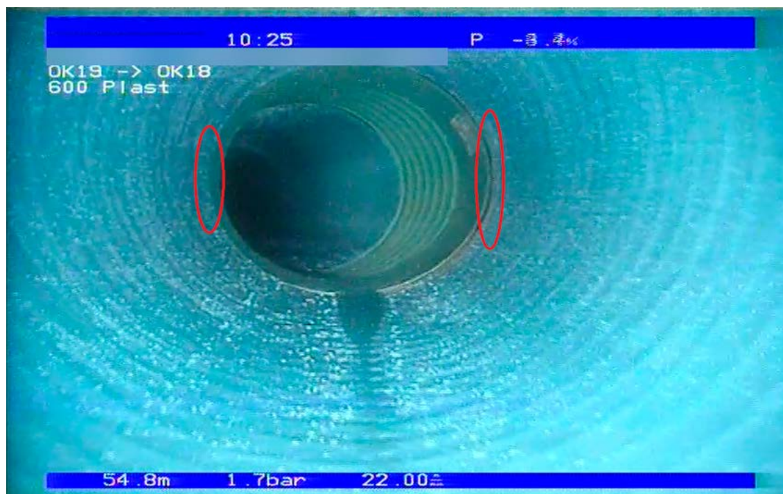
Figur 8-8: For stor vinkelendring i rørskjøt har ført til sammenklemt pakning.
