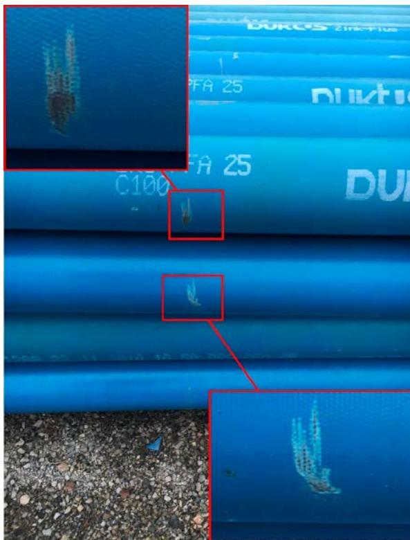
Figur 7-9: Synlig skade på beskyttelsesbelegget rundt støpejernsrøret.
