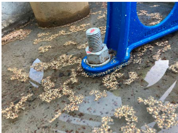
Figur 8-13: Vannstandard ID 602 (tidligere VA/Miljø-blad 112) stiller krav til at bolten skal stikke mellom 6 mm og 25 mm over mutteren etter tiltrekking. Her har mutteren for stor overhøyde, som gir feil belastning og redusert styrke i skjøten.
