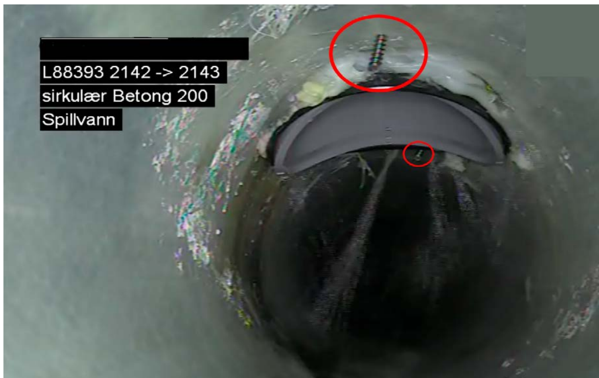
Figur 7-10: Ved rørinspeksjon er det oppdaget skruer som er skrudd inn på røret. Her er sadel blitt skrudd fast med skruer for å holdes på plass.
