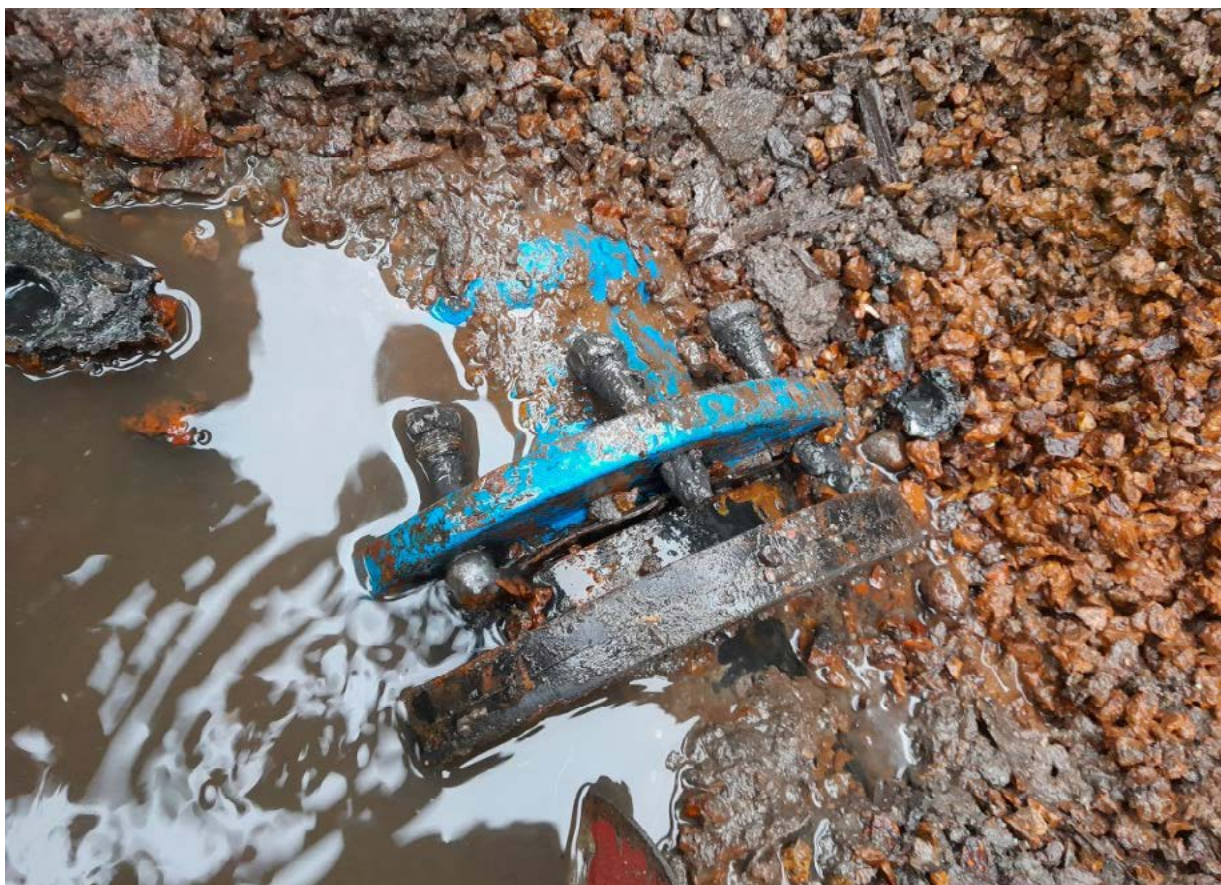
Figur 7-6: Feil i beskrivelsen har ført til bruk av feil bolter i aggressiv grunn, noe som har resultert i rust og brudd. Dårlige grunnforhold burde vært bedre vurdert.
