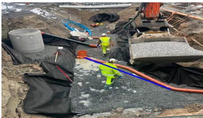
Figur 6-1: I stedet for å legge en rett strekke med rør, slik det er vist med blå linje, er det her blitt benyttet 2x langbend, 2x dobbeltmuffer og 3x kapping og montering. Kostnader knyttet til fremdrift og masser kommer på toppen av dette. En alternativ løsning kunne vært å flytte spylestakekummen ca. 2 meter oppstrøms, noe som ville gitt en penere føring på stikkledningen.
