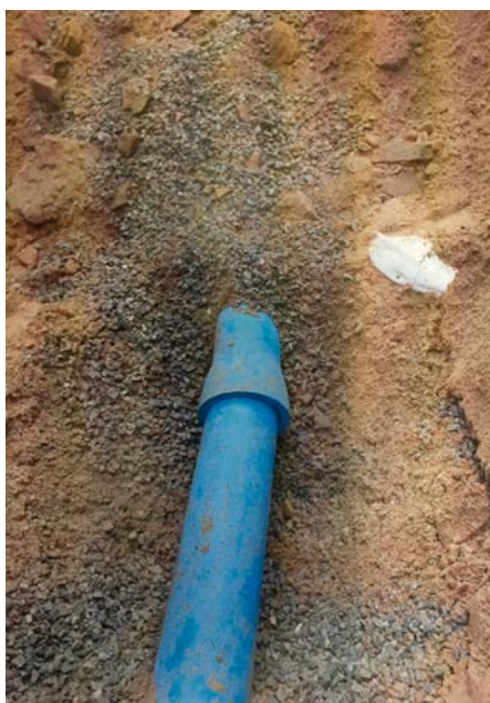
Figur 7-2: Rørskjøt med for stor vinkelendring i forhold til toleransekravet fra leverandør.
