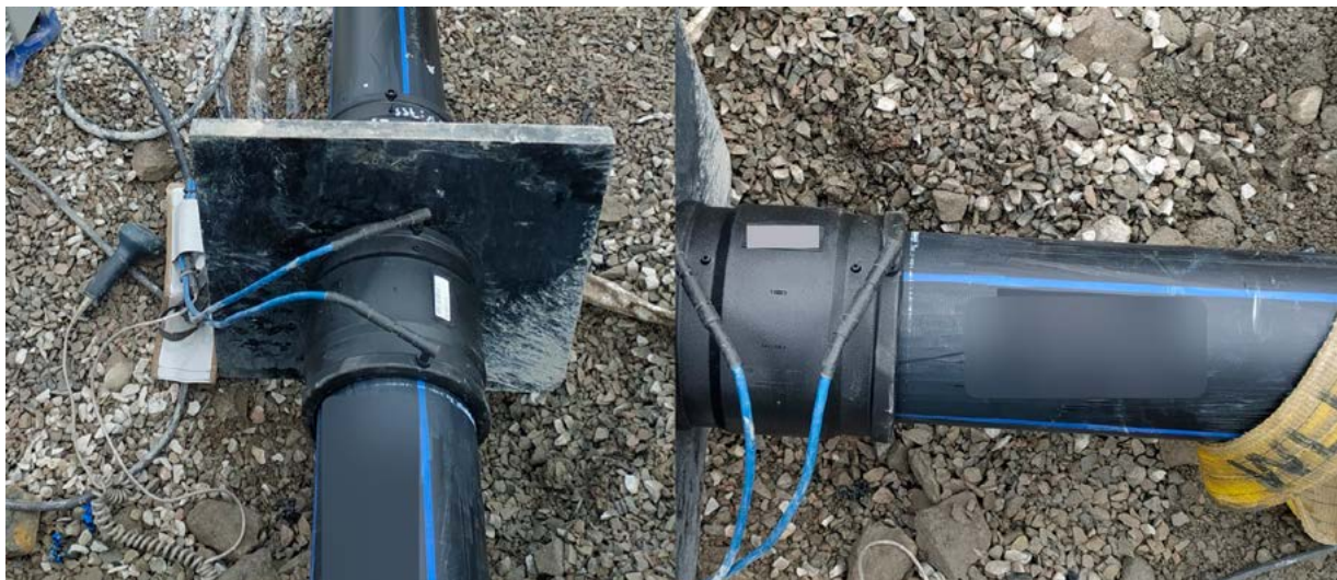
Figur 8-9: Skraping av rør for elektromuffesveis utført med feil verktøy. Iht. NS 416-1 skal røret ha en ensartet skraping hele veien rundt, og denne skal kunne ses klart på begge sider av muffen.
