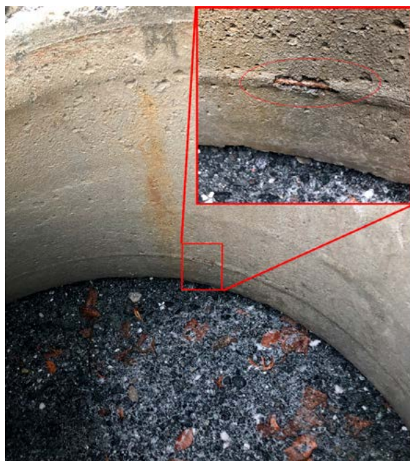
Figur 7-14: Kumring med for lite overdekning til armeringen. Dette er produksjonsfeil, som ikke var anmerket ved mottakskontroll.
