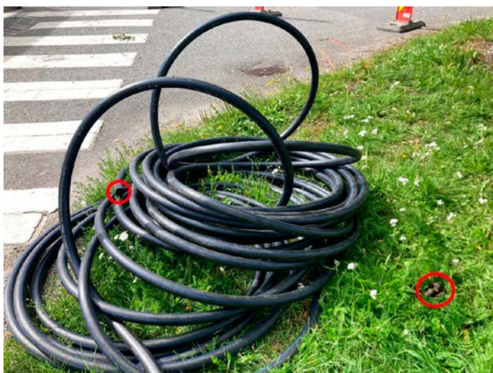
Figur 7-1: Rørenden til vannledningen ligger eksponert rett ved siden av hundeavføring, noe som utgjør en betydelig hygienisk risiko. Selv om desinfisering skal utføres før idriftsettelse, viser dette mangel på holdninger.
