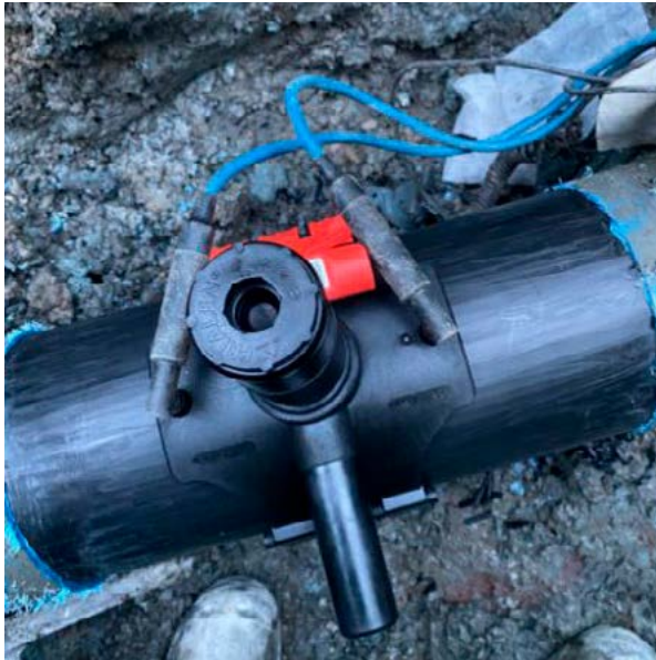
Figur 8-10: Røret er skrapet med håndskrape i stedet for roterende skrapeverktøy. Iht. NS 416-1 skal overflaten være jevn, noe den ikke er her.
