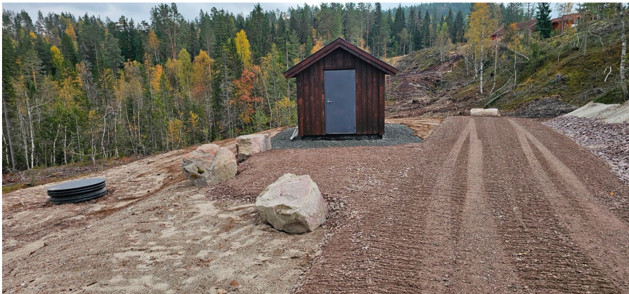
Figur 14: Oppsamling av infiltrert og renset avløpsvann, som ledes til en kombinert pumpestasjon og prøvetakingsstasjon for uttak av mengdeproporsjonale døgnblandprøver. Ådalen RA ved Blefjell. Foto: Bleva ved Dag Åsmund Bilstad, 2025.
