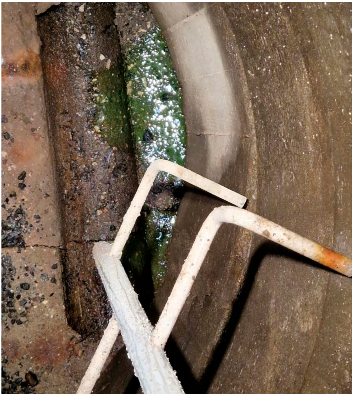
Figur 4: Lekkasje mellom overvannsledning og spillvannsledning. Lekkasje mellom betongrør og strømpekjørt spillvannsledning.
