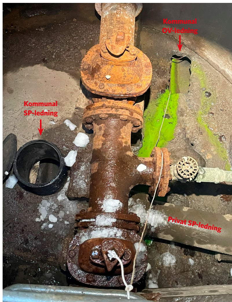
Figur 5: Lekkasje fra privat spillvannsledning i en kommunal kum. Privat spillvannsledning lekker ned i kummen og renner ned i kommunal overvannsledning.
