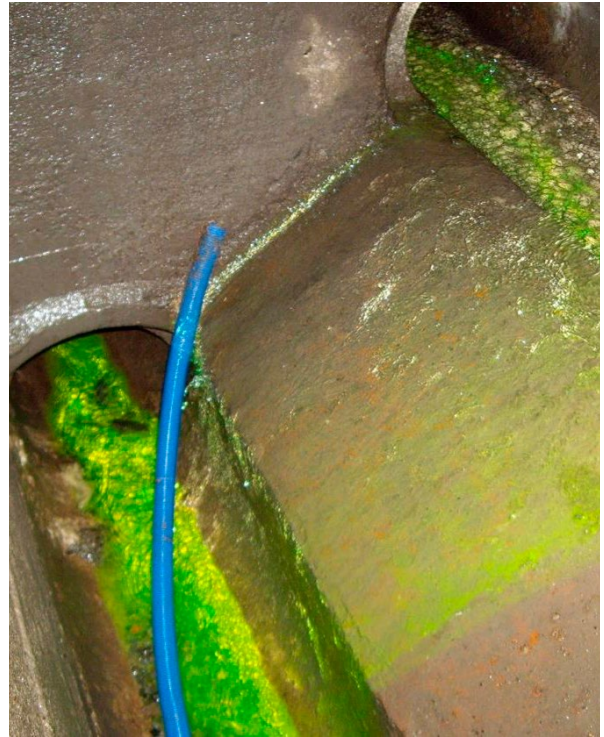
Eksempel på dårlig utforming hvor spillvannet øverst renner over i overvannet.
