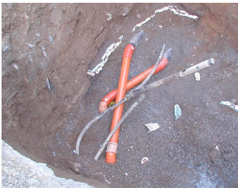
Figur 2: Feilkoblet hus. Huset var feilkoblet ved påkobling til offentlig ledningsnett. Feilen ble oppdaget etter mange år og rørene koblet om.
