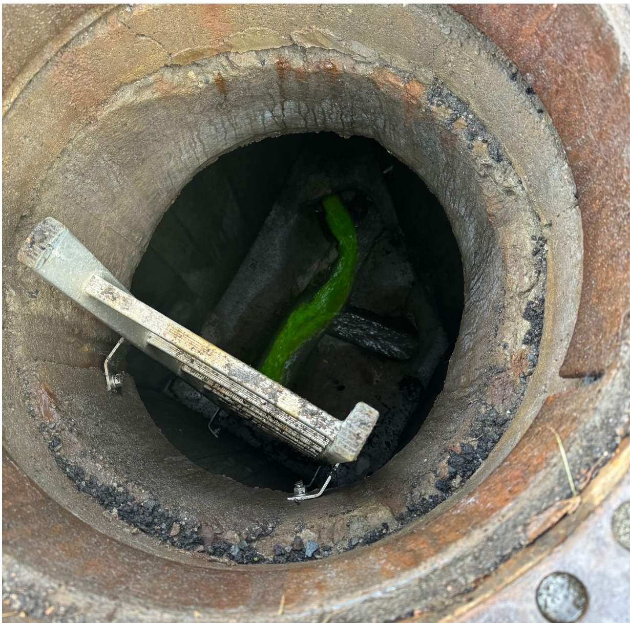
Figur 16: Observert fargestoff i overvannskum etter tilsetting av farge i et toalett.
