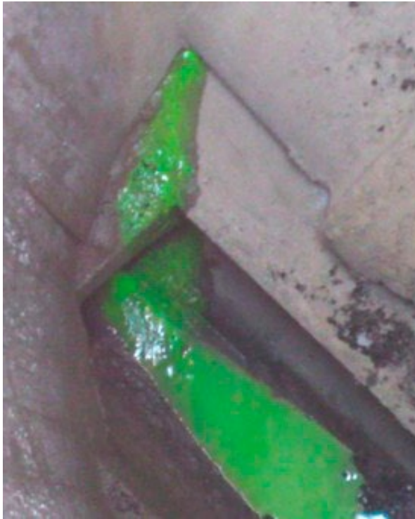
Tydelig lekkasje fra sprekk i spillvannsrør hvor spillvann renner over til overvannet
