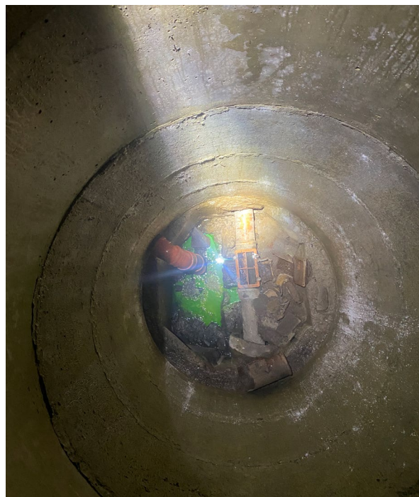
Tydelig grønnfarge i vannet som kommer ut av overvannsrøret. Tydelig dokumentasjon på feil.
