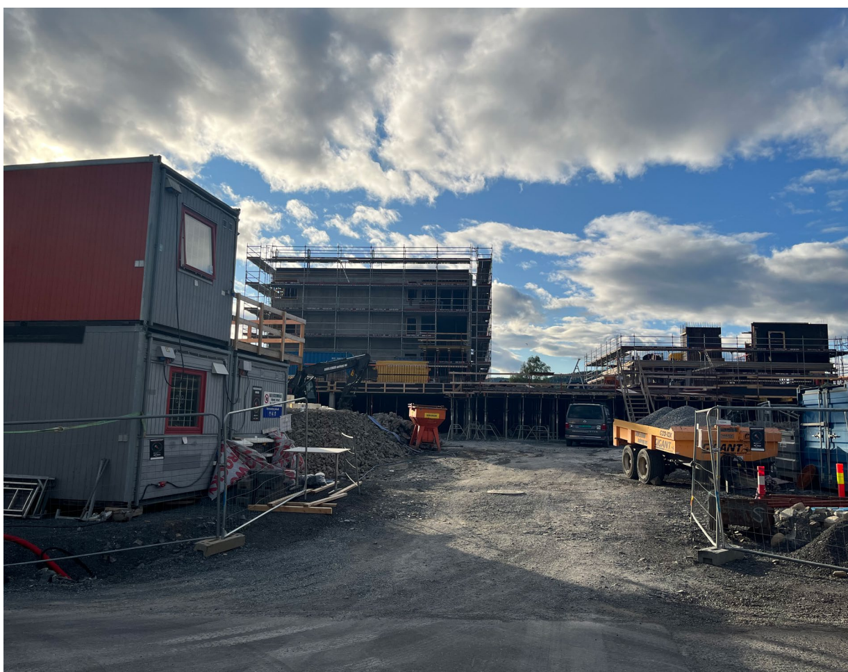
Figur 24: Det kan oppstå feil ved påkobling av brakkerigger og nybygg.
