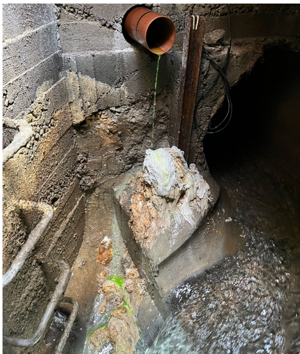
Tydelige spor på en feilkobling hvor avløpssøppel kommer ut av et overvannsrør. Fargetest avdekket og dokumenterte hvor feilen lå.
