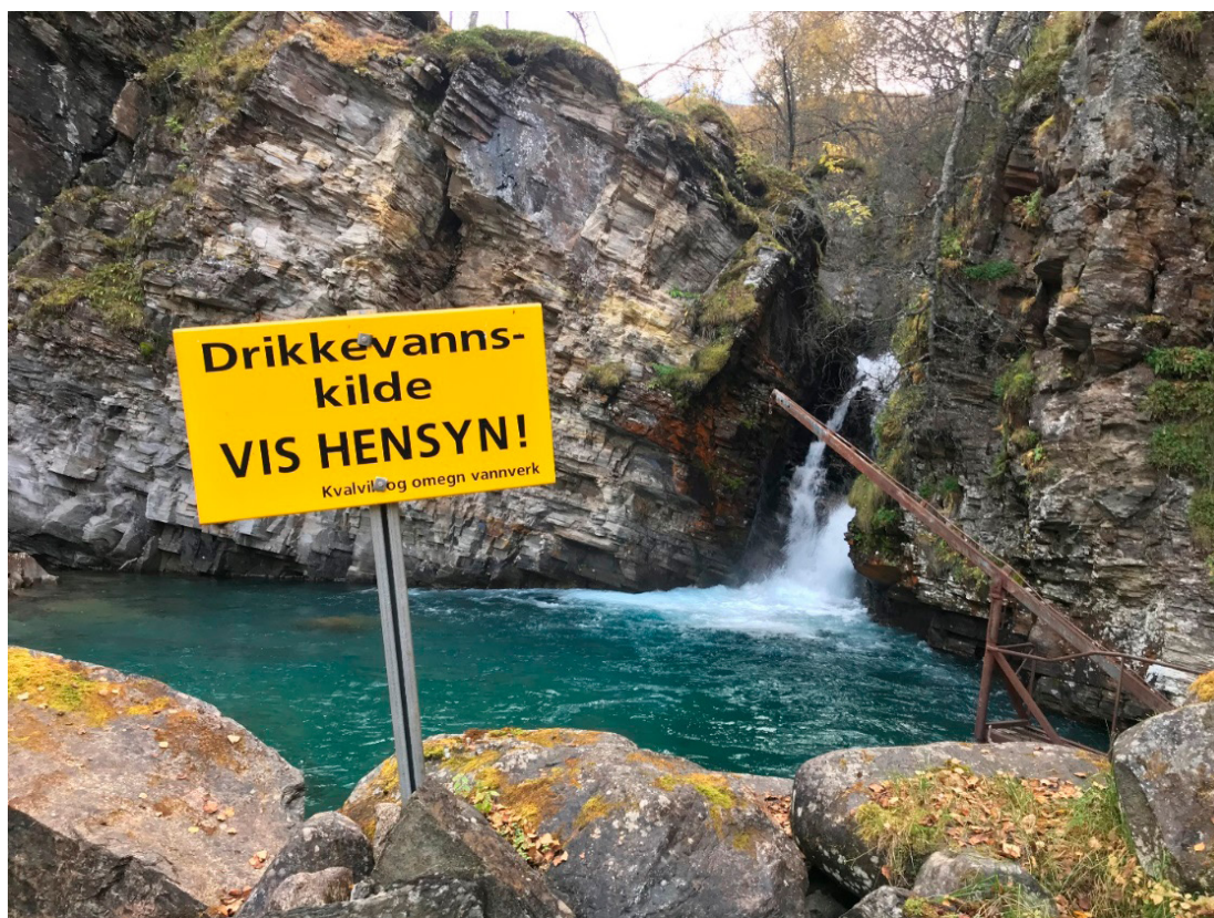
Figur 6-1. Åpent elveinntak i Kvalvikelva. Inntaksledningen går direkte inn i kulpen med en inntakssil i enden. Krana til høyre i bildet er benyttet til å heve inntakssilen for rensing (Foto: Hanne Kvitsand, Asplan Viak AS).
