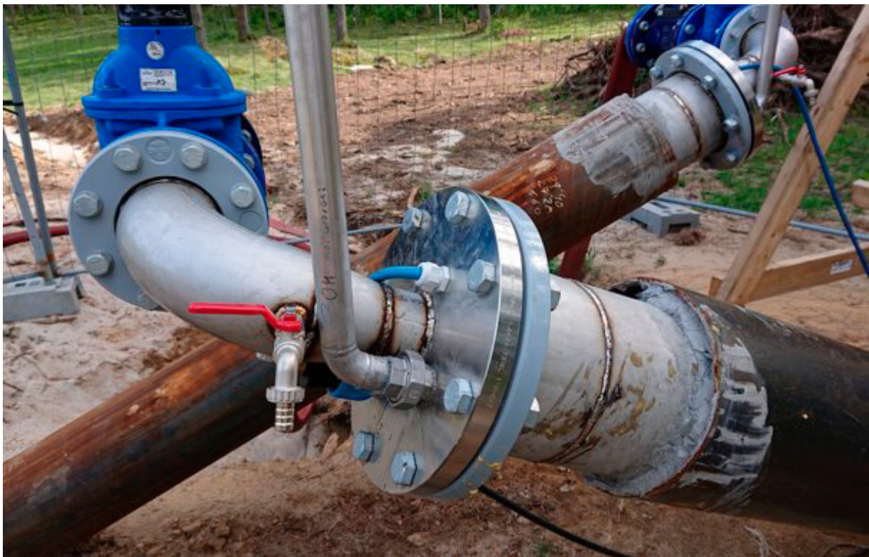
Figur 6-7. To skråborede løsmassebrønner med tette brønntopper. Bentonittfylling mellom foringsrør og brønnrør, tette gjennomføringer for rør og kabler i brønnhatten og tappekran for vannprøvetaking. Brønnene er siden plassert i et felles brønnhus.
