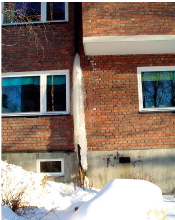
Figur 4-1. Utvendig nedløp fra kompakt tak som har fryst. Foto: Grete Kjeldsen
