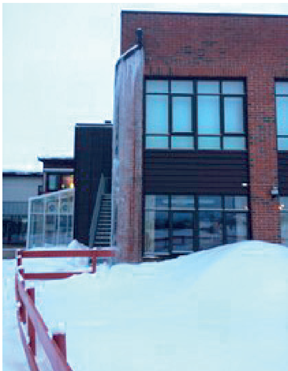
Figur 4-2. Hall i Lier med utvendige nedløp fra et kompakt tak. Frostspreng har ødelagt røret i en kuldeperiode. Foto: Grete Kjeldsen
