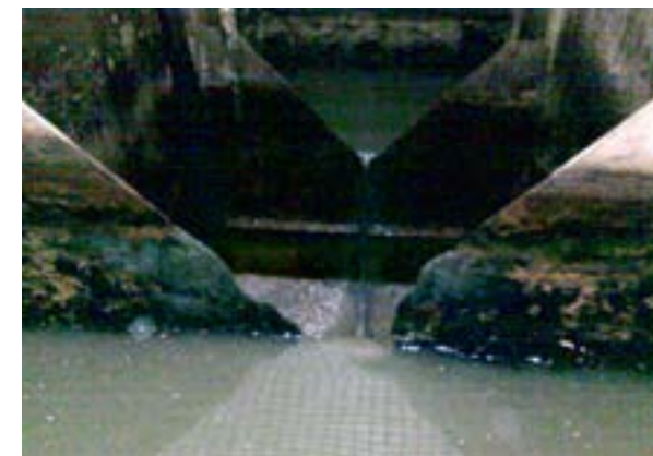
Figur 8 V-overløp som vil gi feil vannføring ettersom overløpsplaten ikke lenger er formet som en V.
