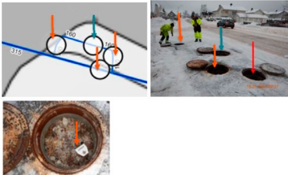
Figur 41: Trykkreduksjonsventil Nyveien/Barkåker (2018). Blå pil viser selve trykkreduksjonskummen. Røde piler angir tilgang til spindler for nedgravde stengeventiler på omløp.
