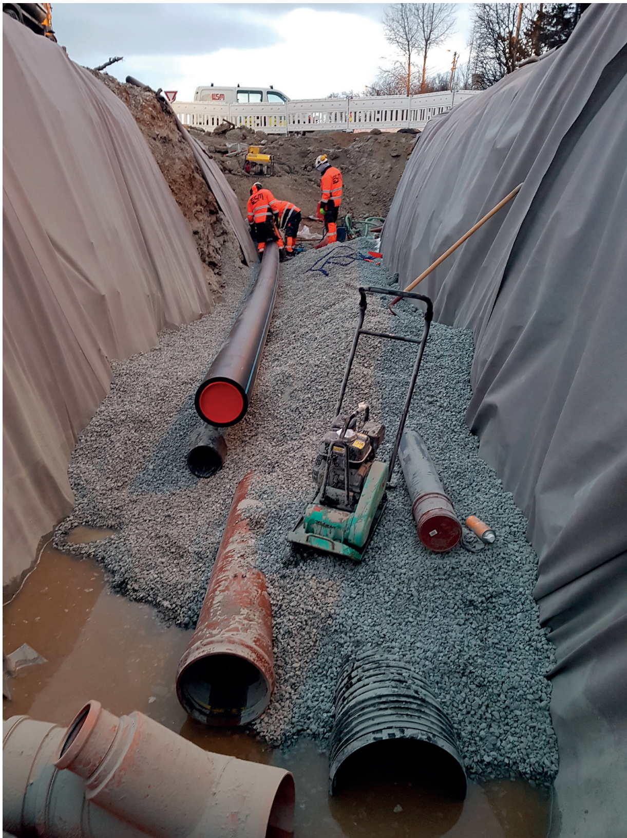
Figur 11: Legging av rør ved bruk av geotekstil (Foto: Einar Sørensen Maskinentreprenør AS).
