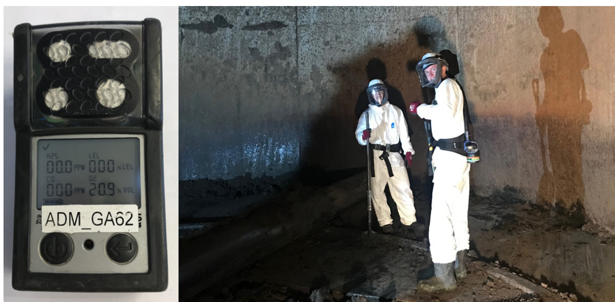
Bilde 2 Arbeider i områder med farlige gasser eller lavt oksygennivå (Foto: Kjell Ivar Gran, VEAS)
