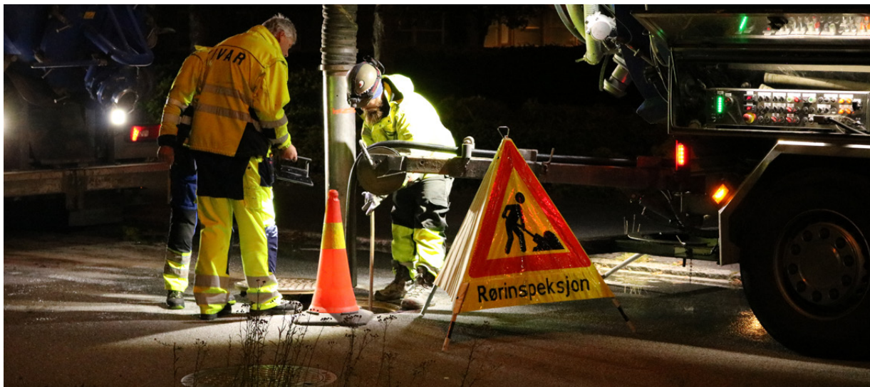
Bilde 5 Spyling og suging, transportsystem avløp (Foto: IVAR IKS)
