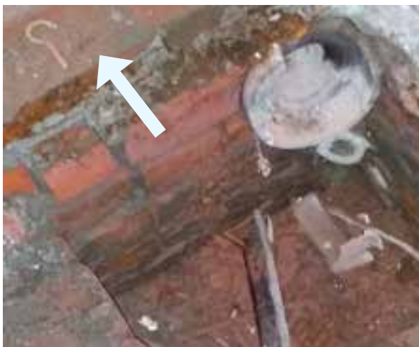
Gammel stake-/spylekum i kjeller hvor støpe-jernsrør viser retning av rørene ut av boligen
