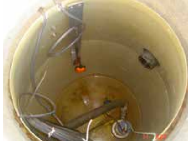
Pumpekum med vippestyrt pumpe og alarm for høyt vannivå, samt krympeskjot på den elektriske tilkoblingen til pumpa. Kummen er tilfredsstillende
