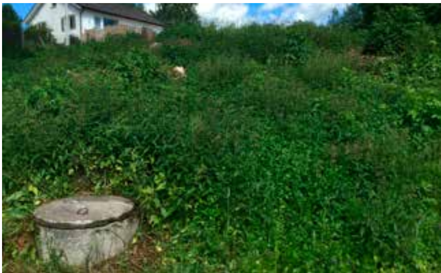
Frodig vegetasjon i skråning hvor det ligger et eldre infiltrasjonsfilter med dårlig fordeling av avløpsvannet
