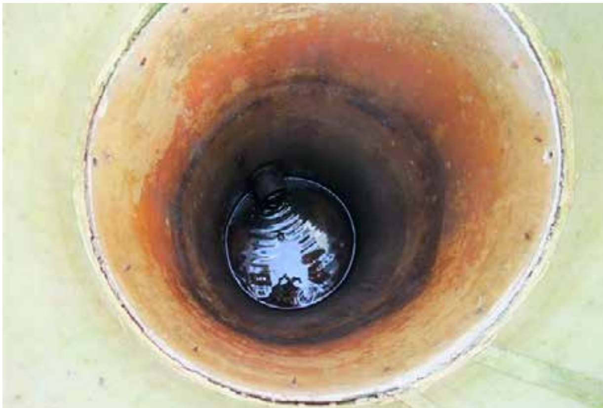
Utløpskum fra sandfilter i glassfiber/plast – noe slam i kummen. Avsetning på kumveggen viser at vannivået i kummen på et tidspunkt har stått høyere enn utløpsrøret.
