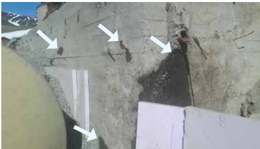
Eldre plasstøpt slamavskiller i betong for turistbedrift. Pilene viser lekkasjepunkter. Ved lengre tid uten tilførsel av avløpsvann stabiliserer vannnivået i slamavskilleren seg ca. 10 cm under utløpsrøret, som gjenspeiler vannutslaget rett under
