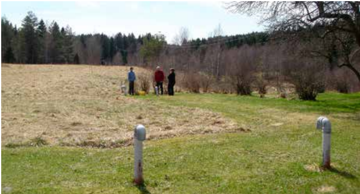
Sandfilteranlegg med to sandfiltergrøfter og lufterør i både innløp og utløp av filtergrøftene, Utløps-/inspeksjonskum i bakgrunnen
