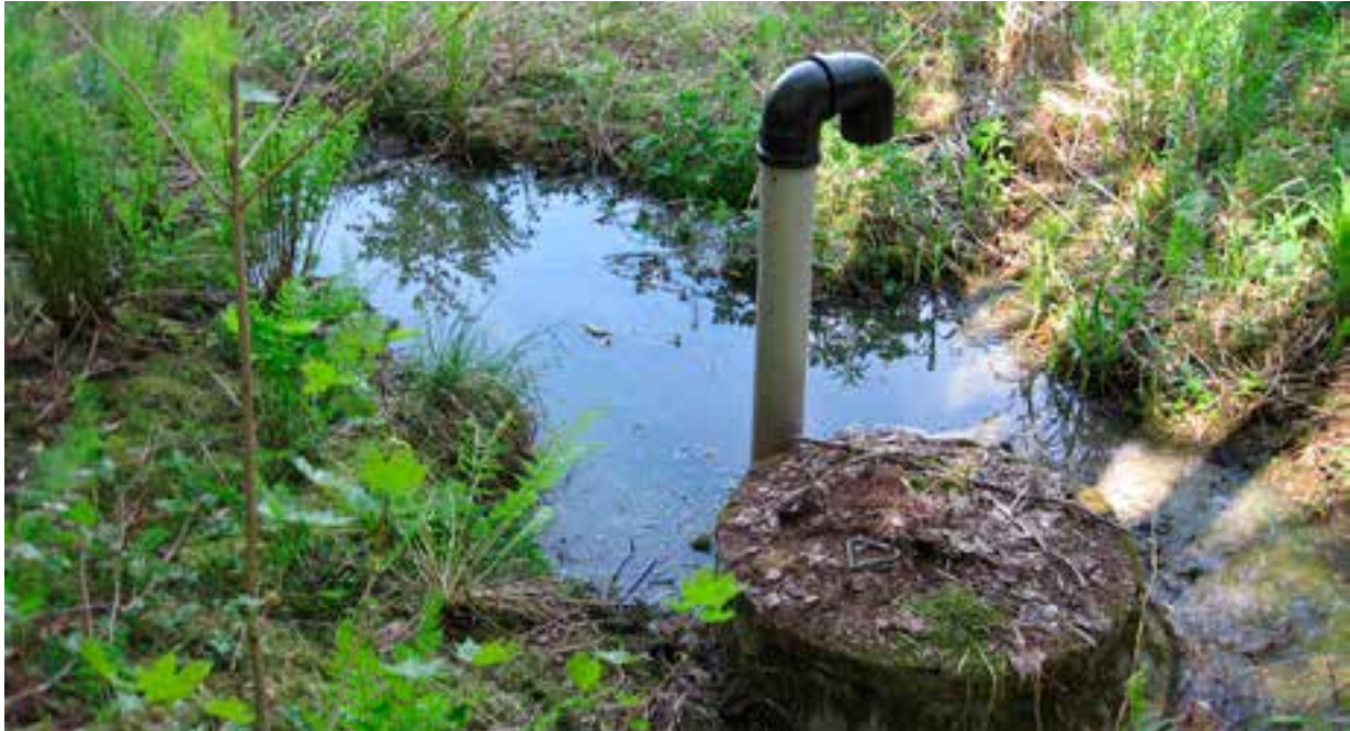
Eldre sandfilter som ikke fungerer hydraulisk – vann har stuvet seg opp til terreng i utløpsenden ved utløps-/inspeksjonskum
