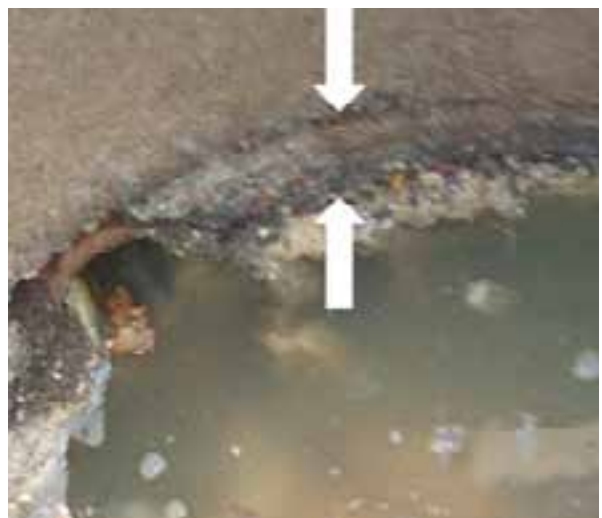
Fettrandens viser at vannivået på et tidspunkt har stått for høyt i kummen
