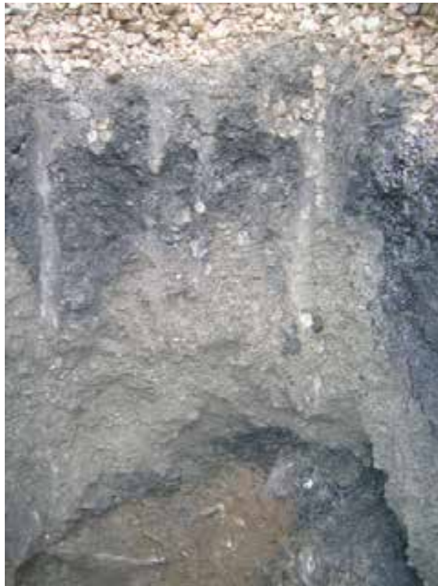
Oppgravd infiltrasjonsanlegg med store kapasitetsproblemer. Bunn infiltrasjonsanlegg er lagt på hardpakkede sand- og grusmasser. Kombinasjon med bruk av uvasket pukk i fordelingslaget medfører at avløpsvannet ikke infiltreres i stedlige løsmasser, men slår ut i kanten av infiltrasjonsanlegget.
