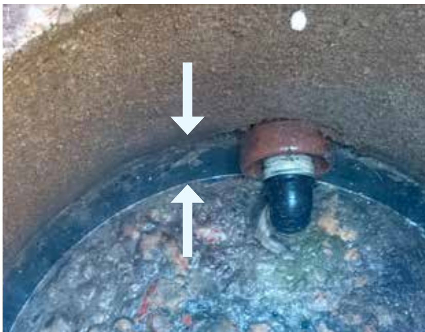
Eldre betongslamavskiller – vannivå lavere enn nedkant av utløpsrør indikerer at det lekker avløpsvann ut av kummen
