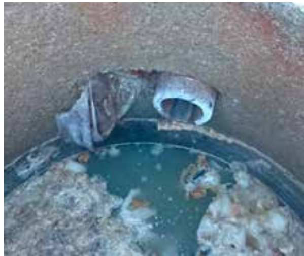
Kumgjennomføringen for avløpsrøret er ikke tett og annet rør ledes inn i kummen - fremmedvann tilføres slamavskilleren
