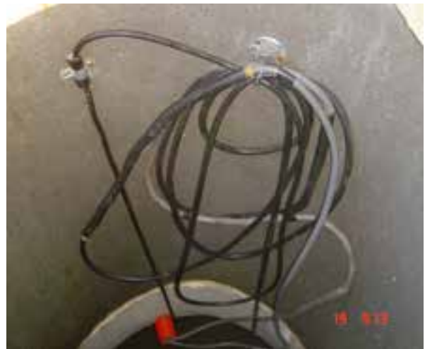
Krympestrømpe, med forsegling av den elektriske koblingen bør benyttes
