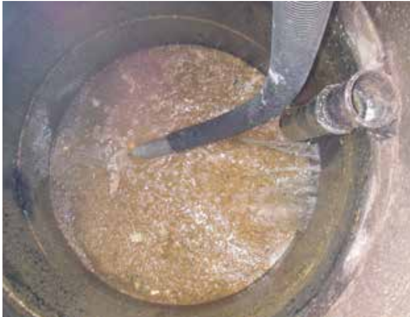
Betongkum med kumsatte ringer – ved tømming av slam, ser man at vann lekker inn i kummen fra omfyllingsmassene rundt kummen
