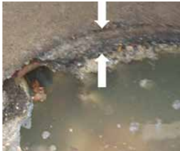
Fettrandens viser at vannivået på et tidspunkt har stått for høyt i kummen
