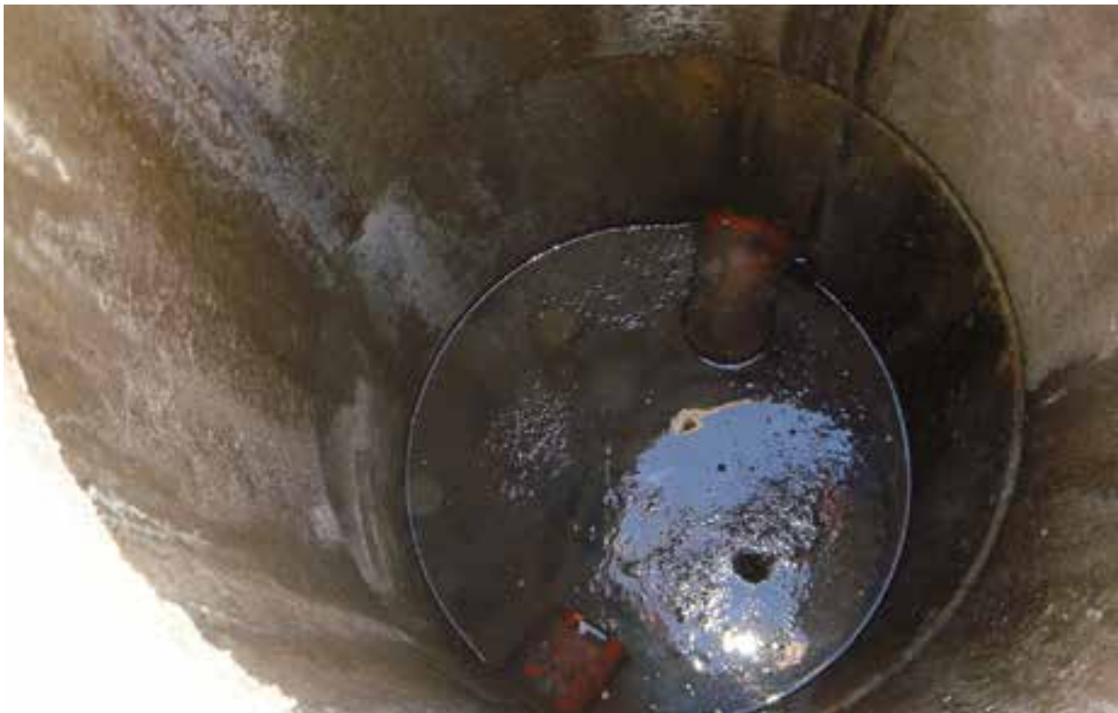
Utløpskum fra sandfilter med kumsatte ringer – en del slam har blitt akkumulert i kummen
