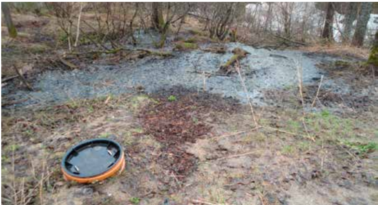
Sandfilteranlegg utformet som basseng og med dårlig fordeling av avløpsvannet på filterflaten – vannutslag av dårlig rensset avløpsvann til terreng i utløpsenden av sandfilteret
