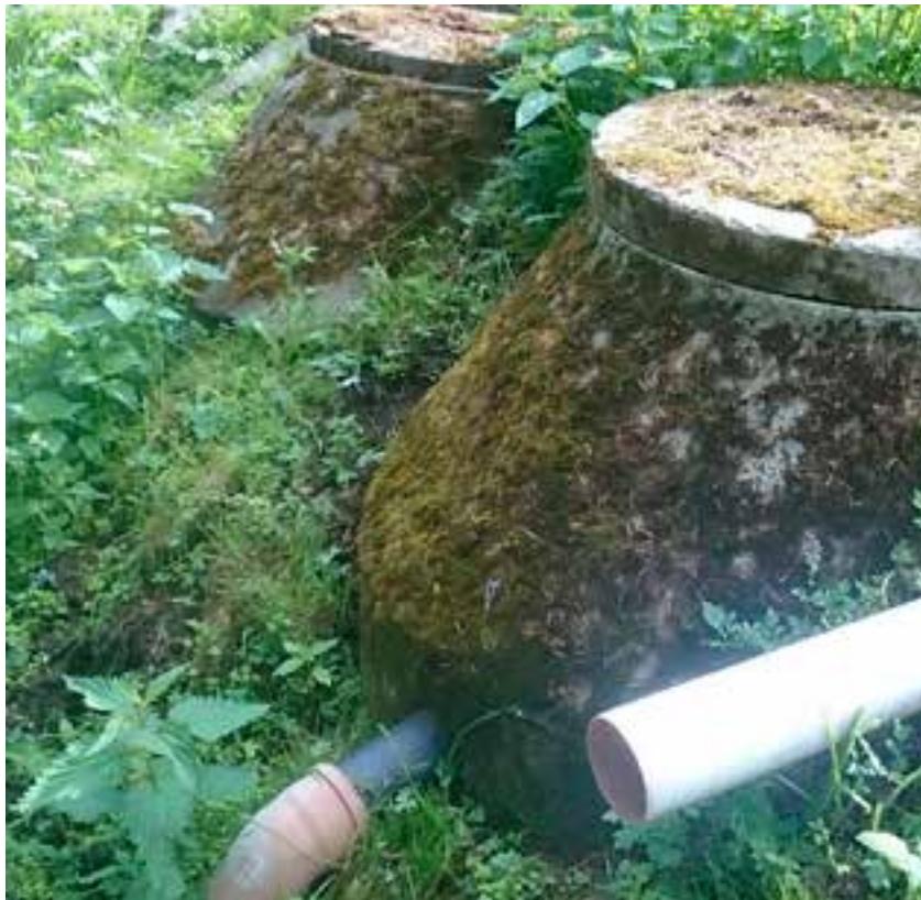
Eldre betongslamavskillere med utløp over bakkenivå – utsatt for frost
