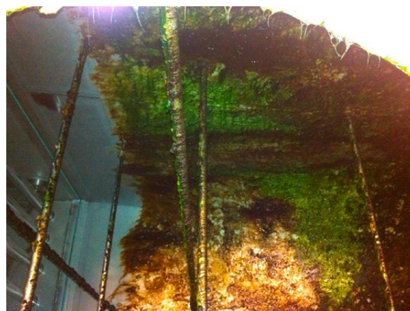
Figur 4-9. Grønnalger i innløpssonen til et UV-aggregat. UV-rørene ses til venstre. Foto: Ulf Eriksson
