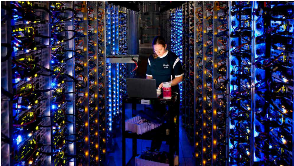
Figur 18. Bilde fra datasenteret til stor skyleverandør (foto: Google)
