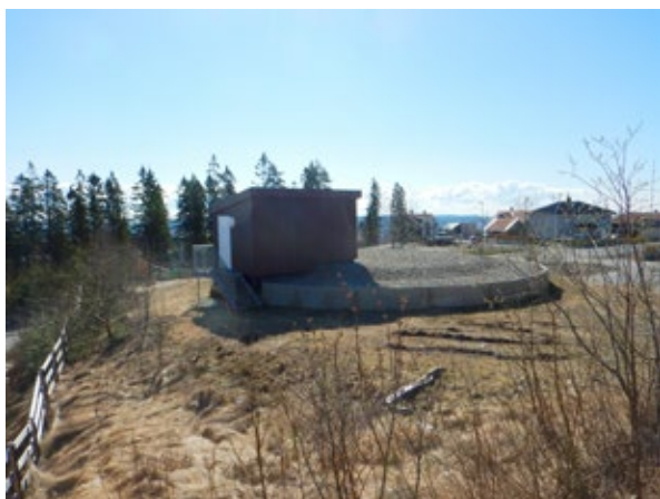
Figur 20 viser nedgravd høydebasseng med overbygg i betong. (foto Ancistrus AS).
