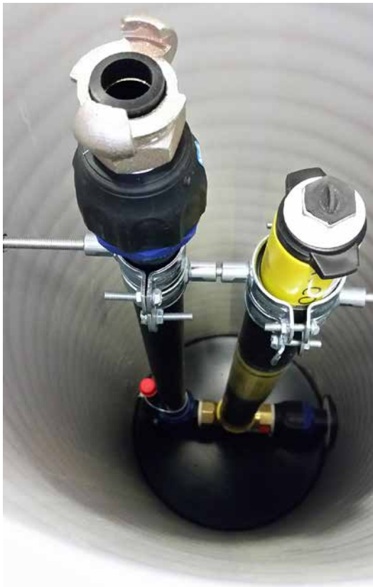
Figur 7: Spylepunkt i kum på trykkavløpsledning. Foto: Isoterm AS
