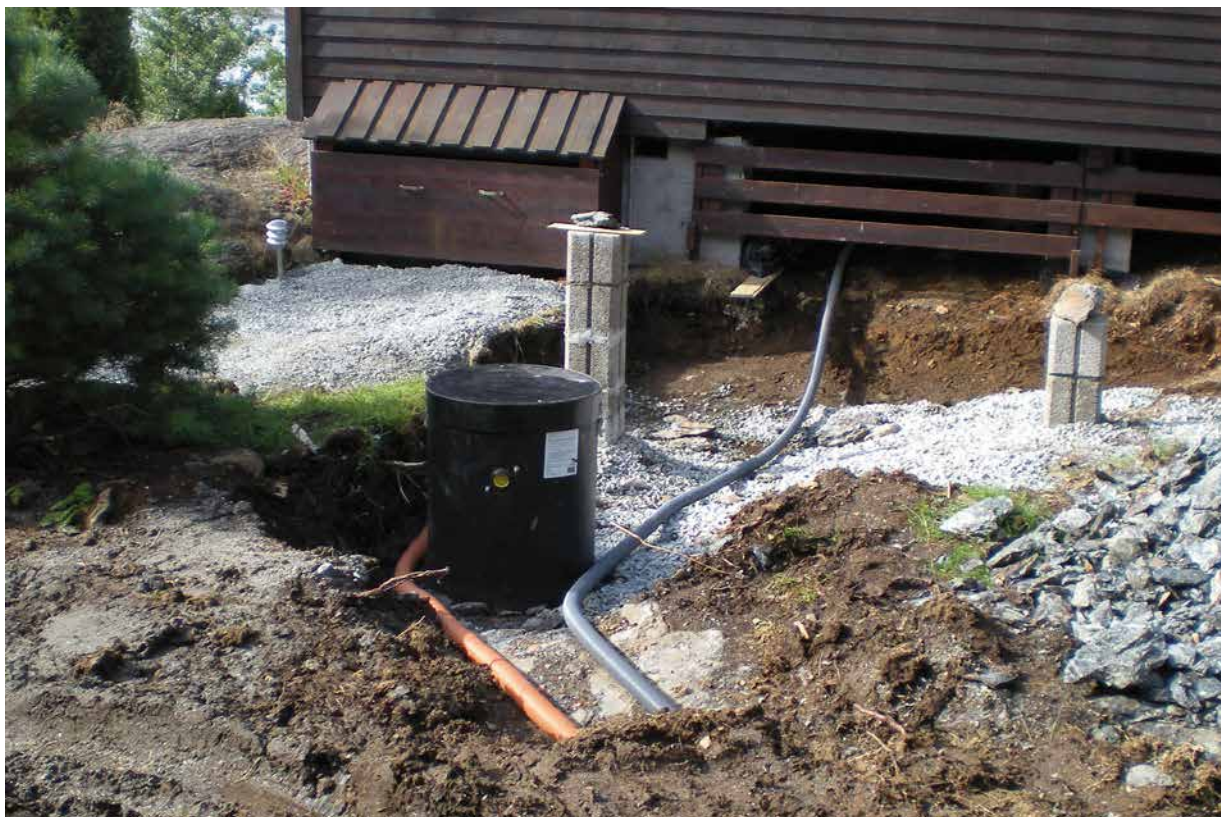
Figur 15: Pumpekum og stikkledninger ved hytte. Foto: Isoterm AS
