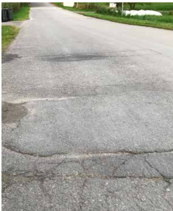
Illustrasjon 15: Gjentatt oppgraving skader veien. Foto: Norsk Vann
