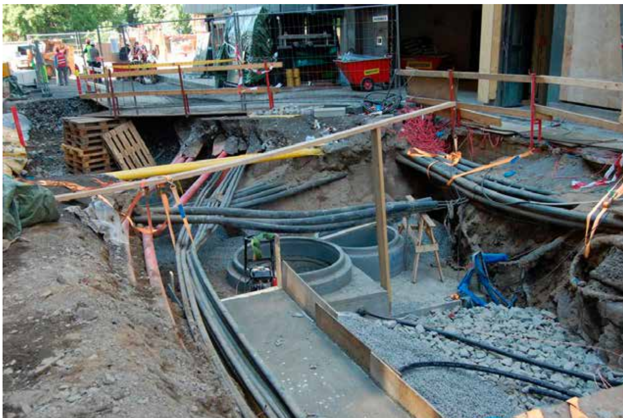
Illustrasjon 9: Utskifting av ledninger i veigrunn kan være komplisert. Foto: Norsk Vann.
