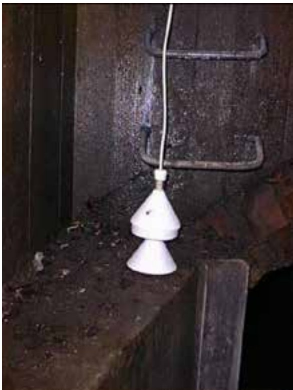
Figur 5.2.1: Enkel mekanisk oppstuvningsmåler montert i kum (privat bilde).
