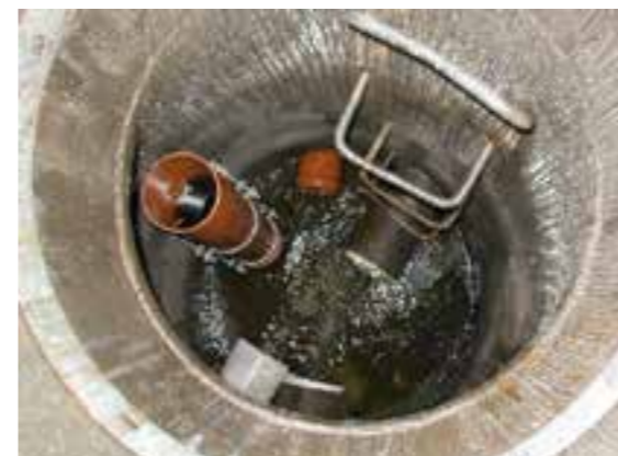
Kum før fornyelse – dårlig hydraulisk utforming
