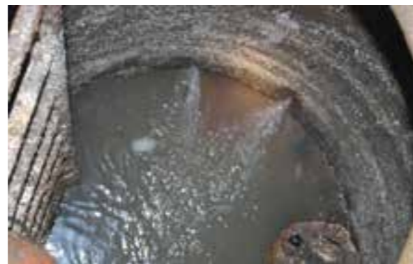
Kum utsatt for innlekkasje gjennom hull og sprekker i kumvegg (Foto: Tromsø kommune)
