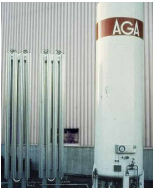
Figur 3-1 Eksempel på oksygentank med fordamper
