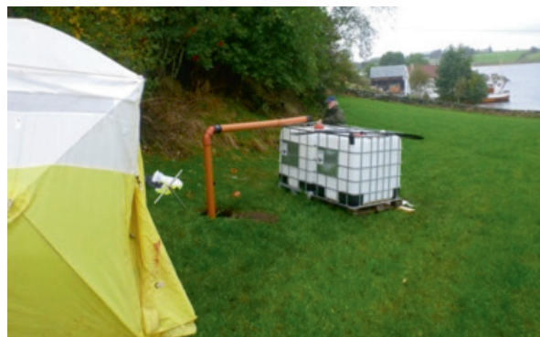
Figur 12. Røroppsett montert på kum for uttak av spylevann (foto: Karl Olav Gjerstad)
