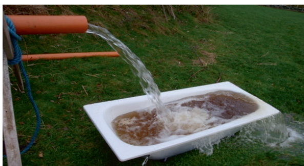
Figur 11. Uttak av slam spylevann fra sjøledning (Foto: Karl Olav Gjerstad)
