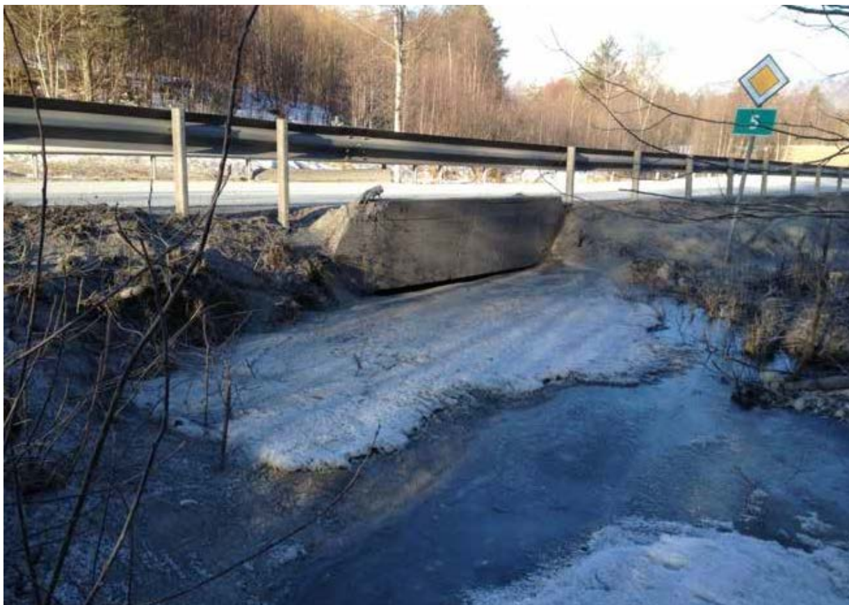
Figur 51. Redusert kapasitet kulvert pga. kraftig isdannelse (Foto: Norconsult)
