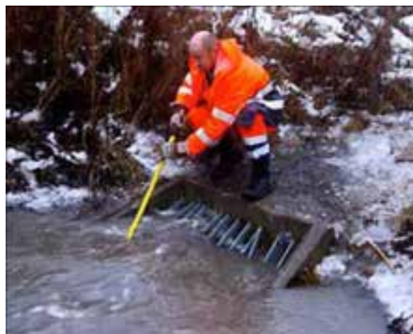
Figur 50. Sikring av flomveger under drift (Foto: Bergen Vann)
