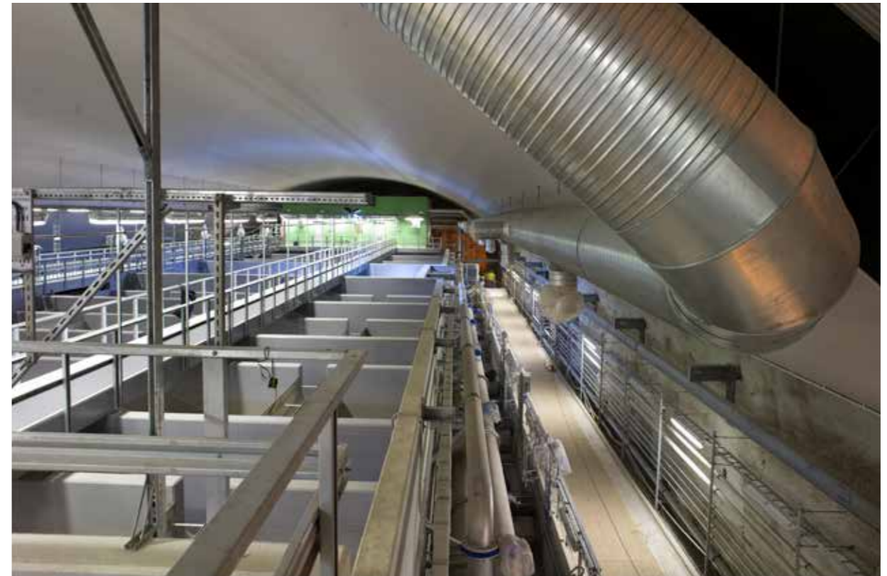
Nye Oset Vannbehandlingsanlegg ble anskaffet som totalentreprise. Foto: CF-Wesenberg/Kolonihaven.no
