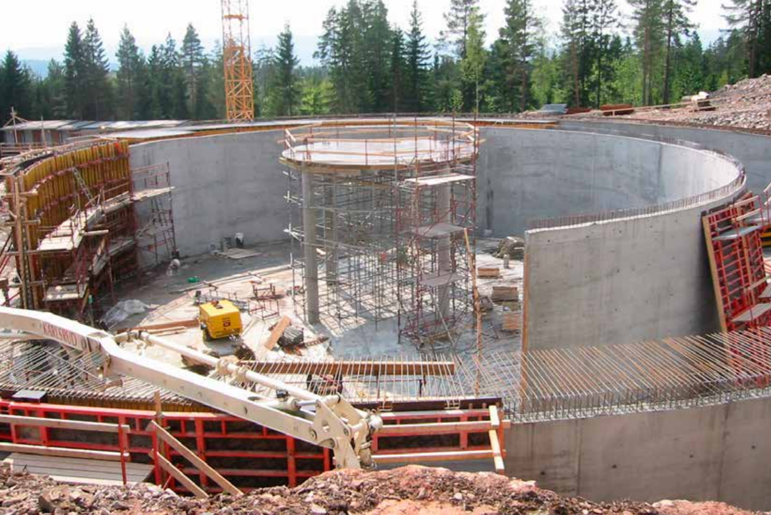
Byggingen av reserv vannforsyning for Asker kommune og Glitrevannverket ble gjennomført som byggherrestyrte delte entrepriser.
