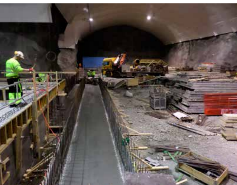
Oppgradering av Flesland avløpsrenseanlegg. Alle arbeider med fjellanlegg, bygg, VVS og elektro ble anskaffet som byggherrestyrte delte entrepriser. Foto: Bergen kommune
