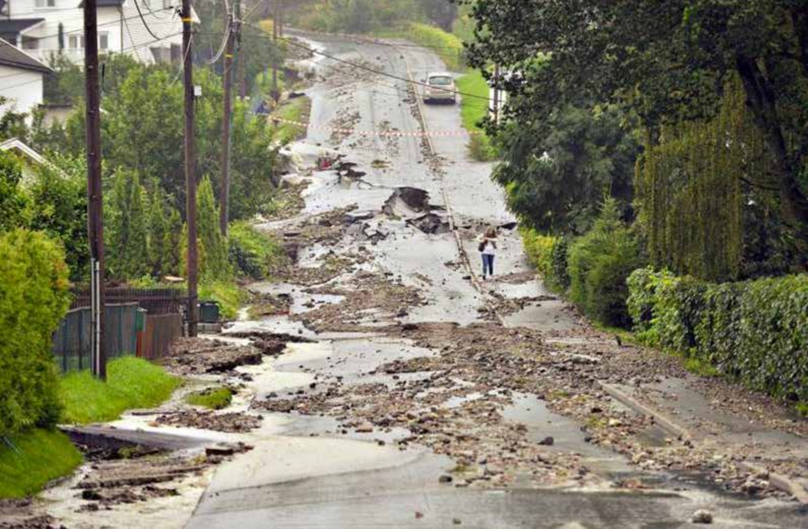
Frida traff Nedre Eiker 6.august 2012. Vannet flommet overalt og det var forsikringsskader for mer enn 300 millioner kroner.
