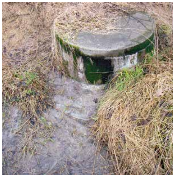
Høy vannstand i slamavskiller. Foto: Stange kommune
