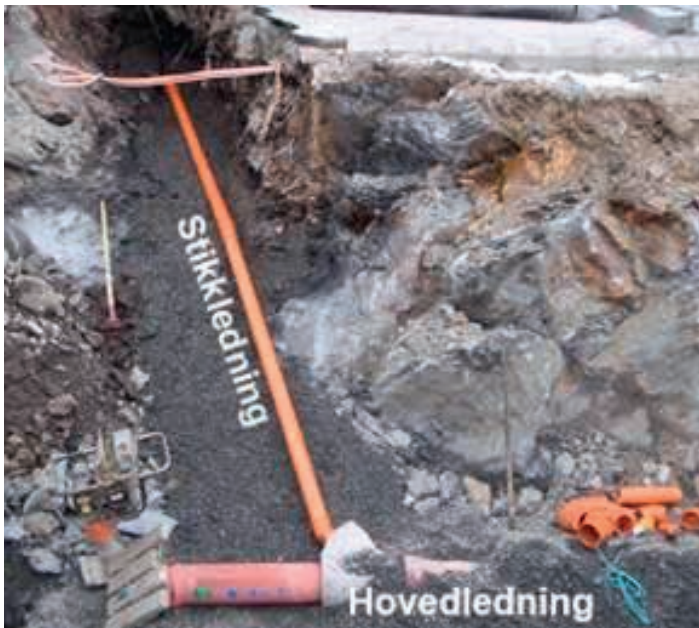
Figur 14. Stikkledning og hovedledning (foto: Stavanger kommune)
