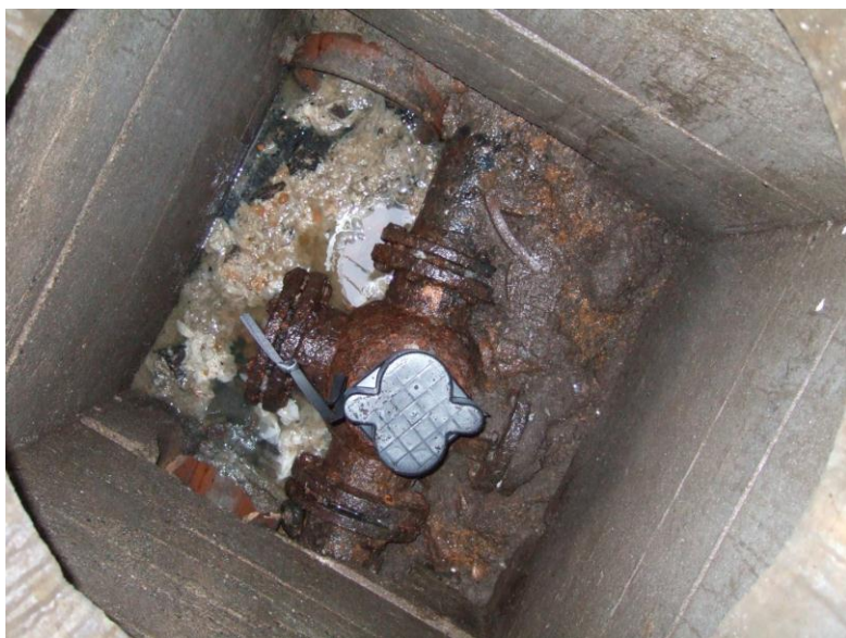
Figur 31. Eksempel på felleskum for vann og avløp. Gammel vannarmatur og dårlige hydrauliske forhold for avløp. Brannventilen er beskyttet med brannventilsikring og beskyttelseshette, for å redusere faren for innsug av forurenset vann. (Foto: Asplan Viak)
