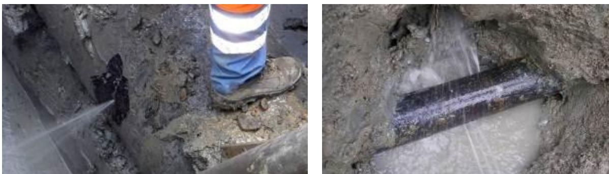
Figur 24. Eksempler på lekkasje på vannledninger av duktilt støpejern (Foto: Asplan Viak og Trondheim kommune)
