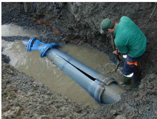
Figur 1. Sprukket ledning av PVC (Foto: Øvre Eiker kommune)
