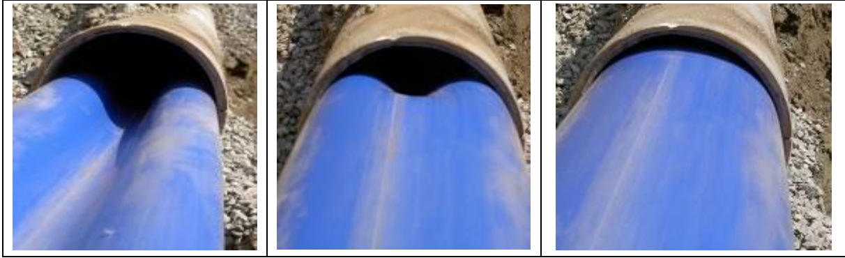
Figur 56. Tetttilsluttet rør (CompactPipe) er ført inn i gammel vannledning, og blir utvidet med varmluft og trykk (Foto: Asplan Viak as).
