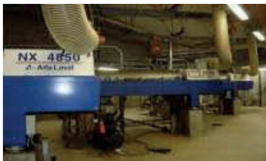
Figur 9: Sentrifuge for avvanning fra Alfa Laval (Bekkelaget RA)
