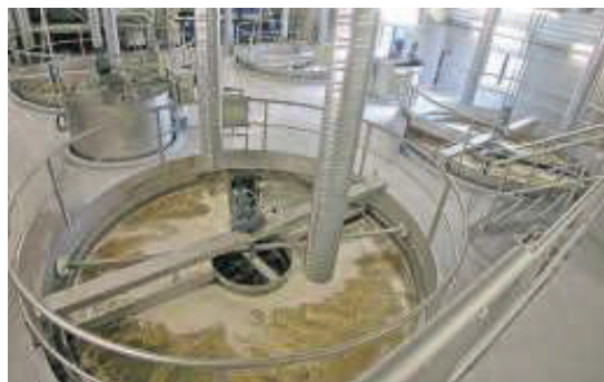
Figur 6: Flotasjonsanlegg fra Krüger Kaldnes AS (type Musling)
