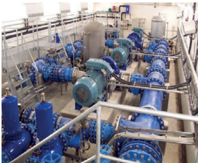
Figur 5.4.1. Pumpestasjon for vannforsyning. (RGA: Reservevannprosjektet Glitrevannverket – Asker kommune/arkivbilde Norconsult AS)
