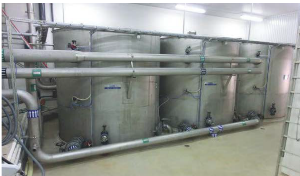
Figur 9-5 Ettermonterte poleringsfiltre med aktivt kull ved Åby vattenverk i Norrköping i Sverige (Foto: F. Ording).
