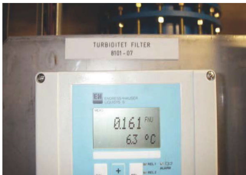
Figur 4-2 On-line turbiditetsmåling på utløpet av hver filterenhet.
