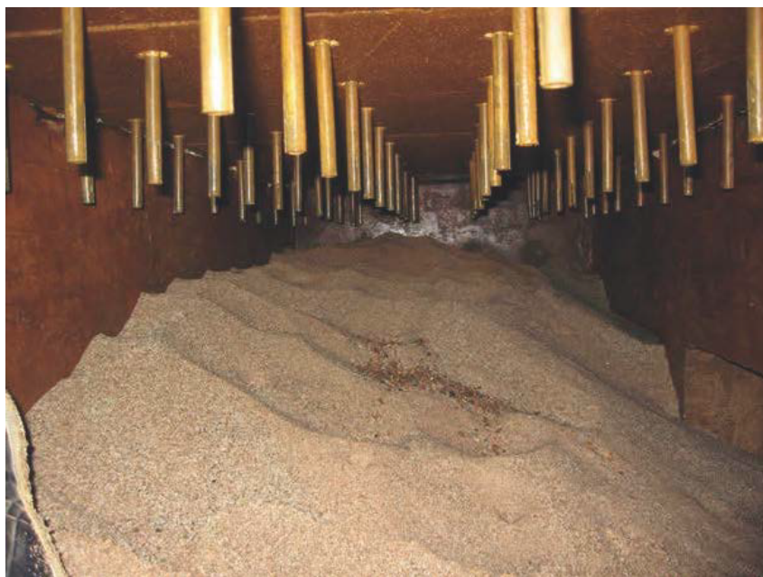
Figur 7-5 Filtersand som har samlet seg under dysebunnen i et filter. Øverst ses innløpet til dysene som stikker ned under betongplatene
