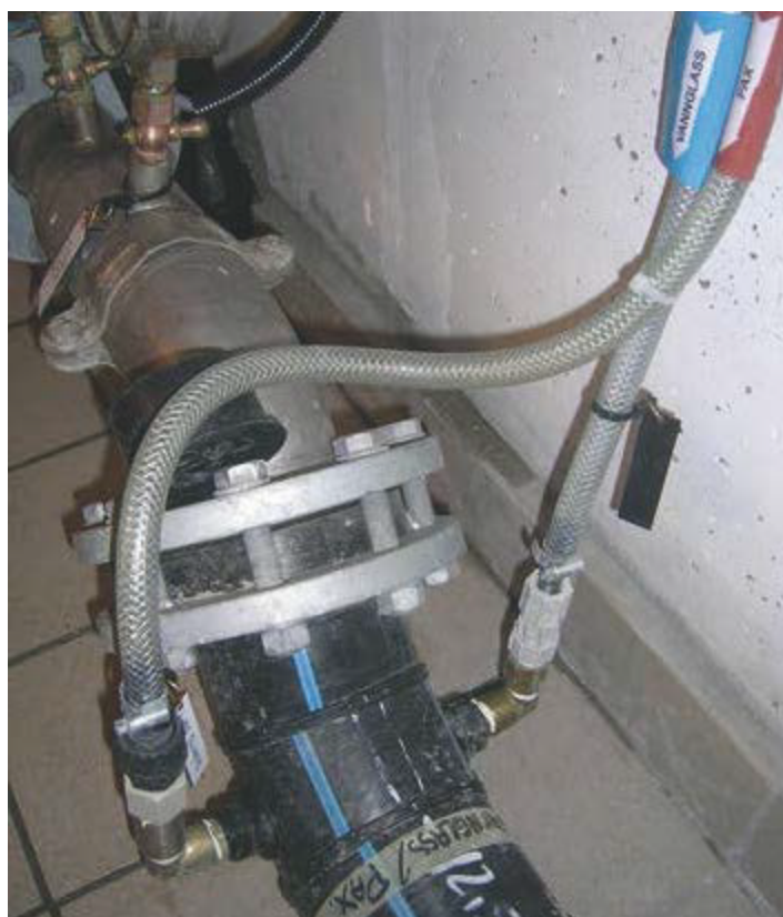
Figur 6-1: Eksempel på uheldig utforming av kjemikalietilsetting. PAX doseres via slangen til venstre, vannglass til høyre. Det kan gi dårlig resultat når vannglass og PAX "blandes med hverandre" før den ene er fullstendig utblandet i råvannet.
