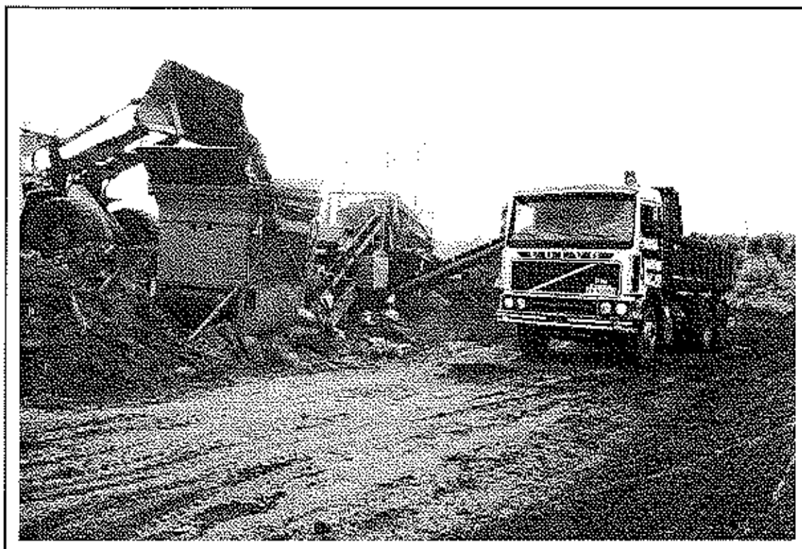
Påfylling av masser med skuffe. Harping. Ferdig harpede masser tømmes på lasteplanet.
