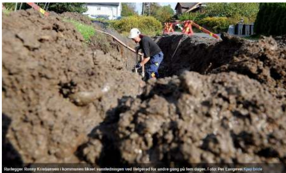
Rørlegger Ronny Kristiansen i kommunen fikset vannledningen ved Helgerød for andre gang på fem dager. Foto: Per Lungevik/Kjøp bilder
